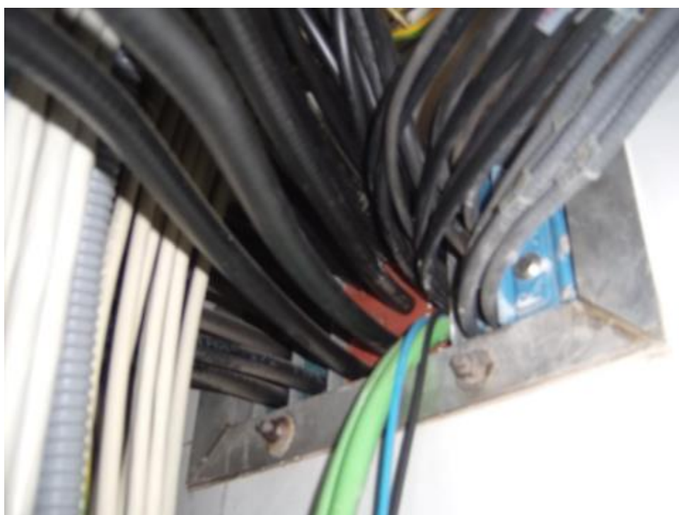
Figura 7.9: pasamuros de entrada a caseta.
