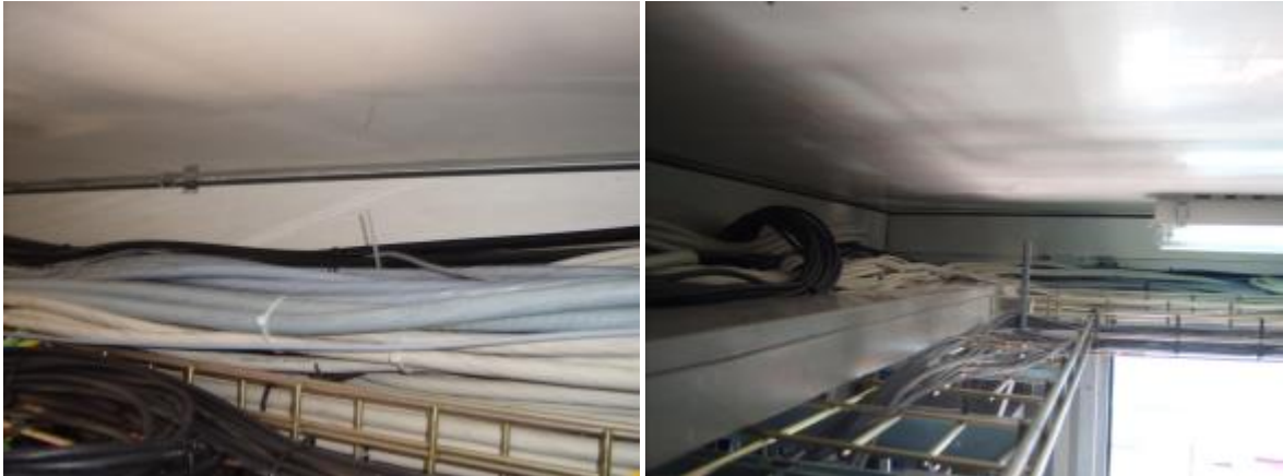
Figura 7.10: cableado en rejiband de caseta.
