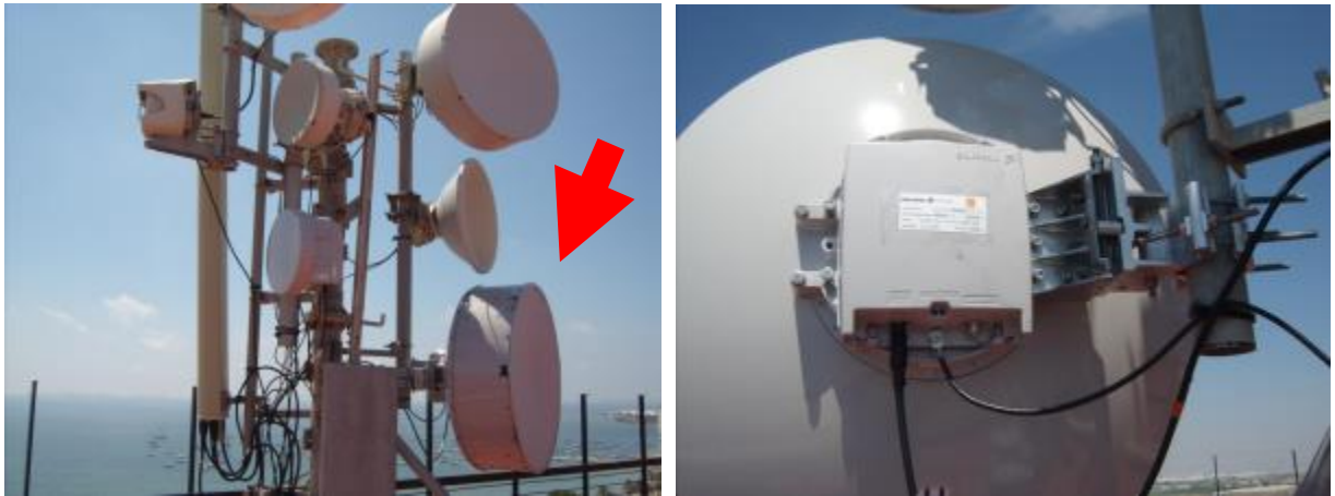
Figura 7.2: parábola y radio del radioenlace MW_MUR5 en el emplazamiento MUR_A.
