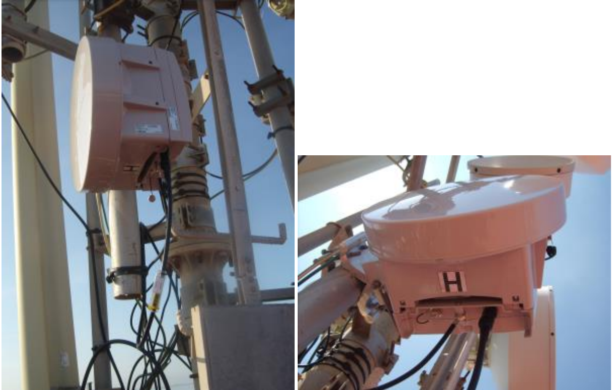
Figura 7.4: parábola y radio del radioenlace MW_MUR1 en el emplazamiento MUR_A.
