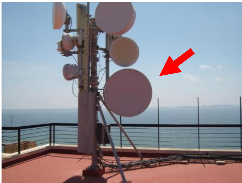
Figura 7.1: panorámica del radioenlace MW_MUR5 en el emplazamiento MUR_A.
