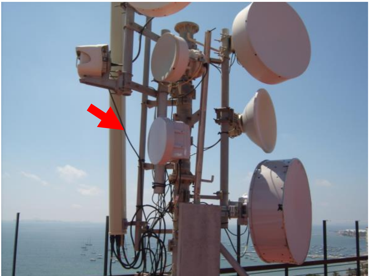
Figura 7.3: panorámica del radioenlace MW_MUR1 en el emplazamiento MUR_A.
