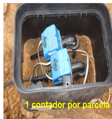
Imagen 2.3. Contadores y tubos de PE
