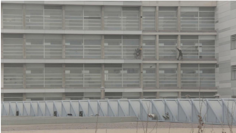
Fig. 24. Fotograma de la grabación original, con dos obreros intentando pasarse un cubo.
