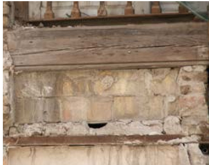
Fig.69,70 y 71. Cerramientos de fachada y patio interior formados con ladrillo macizo de diferentes espesores, entre medio pie y dos pies de espesor en el barrio de Russafa Fotografía: Jiménez Alcañiz, César
