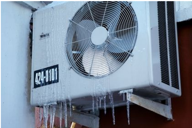
Figura 3.1.- Equipo exterior bomba de calor. (INTERNET)
