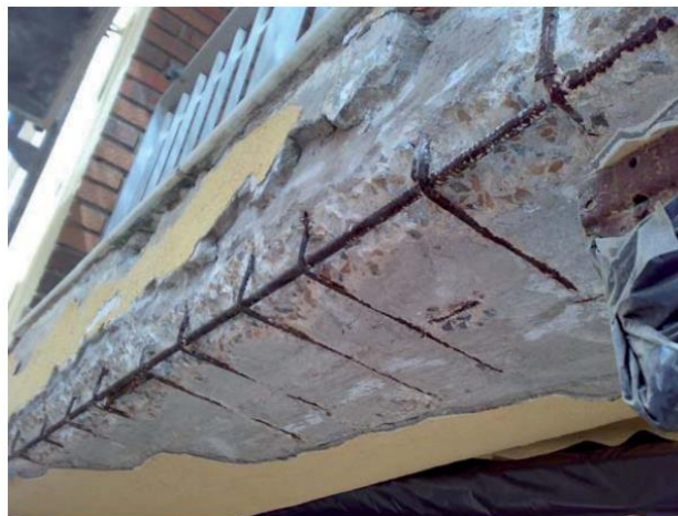
Foto 22: Corrosión de armaduras en un edificio cerca de la costa. Fuente: Eduardo medina, CEDINOX.
