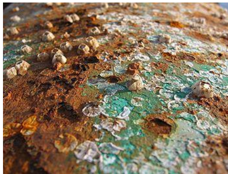
Foto 7: Superficie metálica atacada por agua marina.
