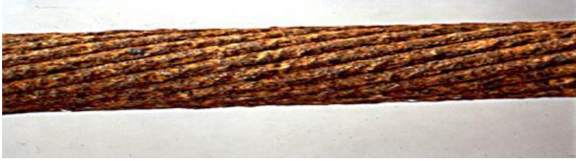
Foto 17: El estriado puede comportarse a efectos prácticos como una grieta y favorecer este tipo de corrosión.
