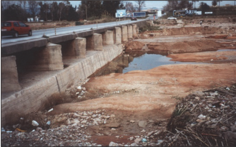
Figura 2. Erosión aguas abajo del Puente de Canet
