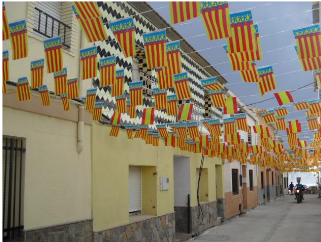
Figura 220: Obra de intervención en fachada con división de materiales por planta e incorporación de alicatados
