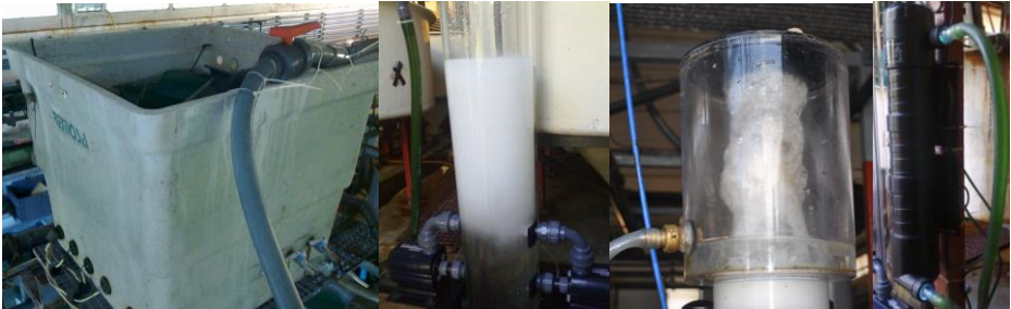
Figura 14. Componentes de filtración del agua del sistema.
