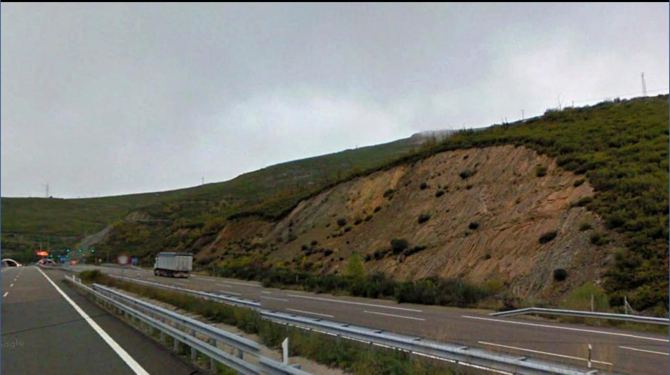
Mataestabilidad en los taludes de la A52. SW de Las Hedradas, Zamora. Pizarras y cuarcitas del Ordovícico. SE Hoja de La Gudiña.
