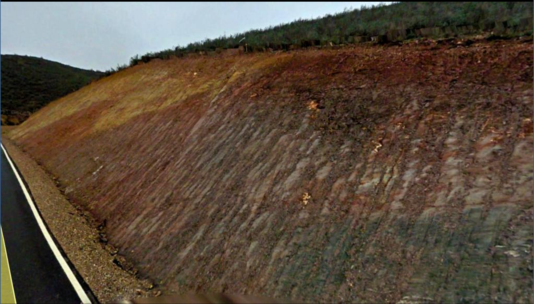
Talud en los esquistos del Precámbrico-Cámbrico. NE de Almaraz de Duero, Zamora. NE Hoja de Pereruela.
