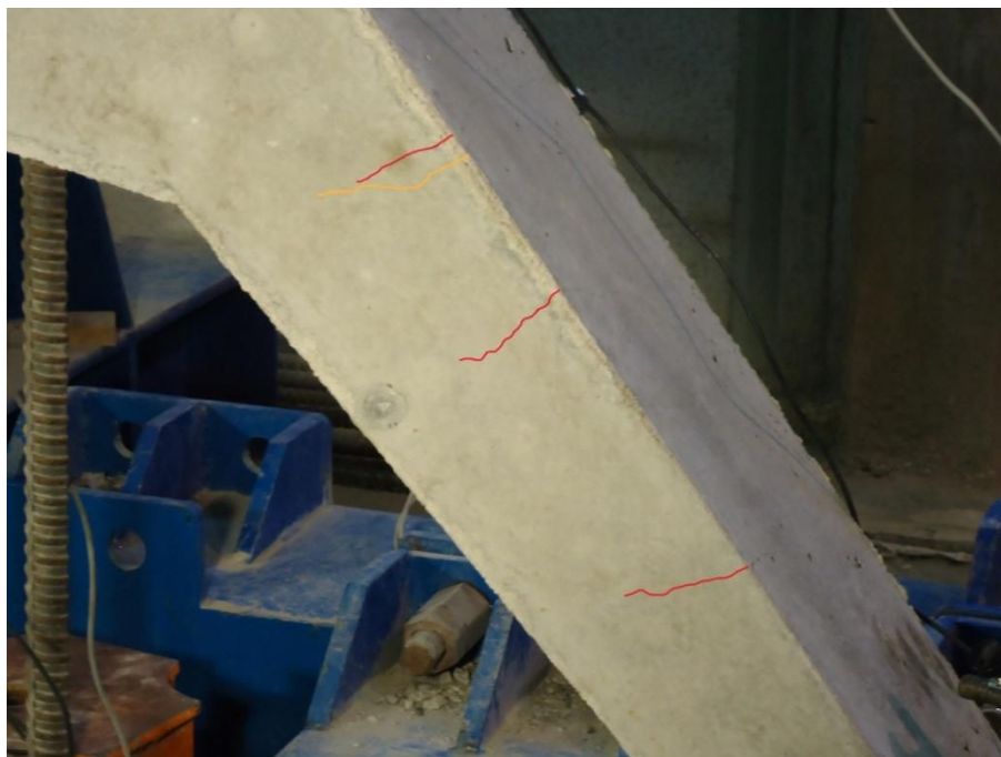
Figura 10.8. Representación de fisuras en la pila derecha sobre una imagen tomada a una carga de 126 kN.
