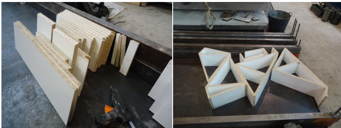
Figura 8.2. a) Listones de madera tras el corte en bisel; b) Bloques del encofrado contruistos a partir de los listones.
