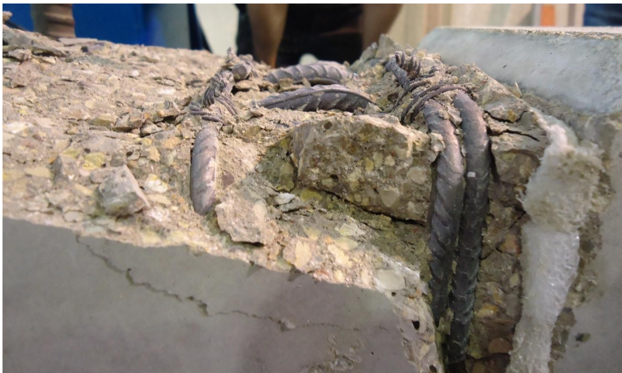
Figura 10.11. Pandeo de las barras pasantes de la rótula.
