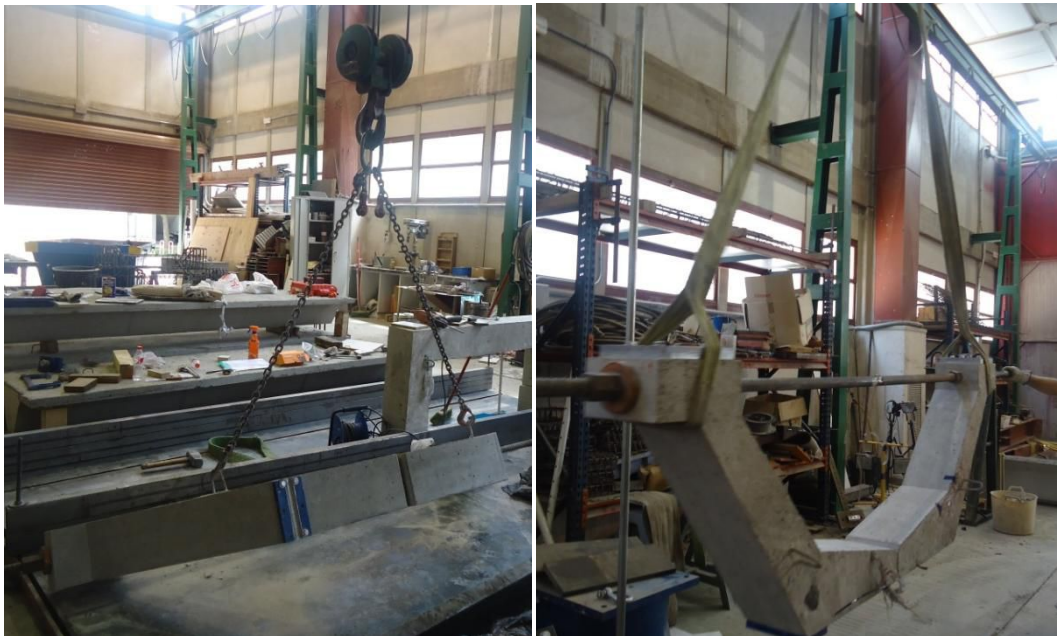
Figura 9.5. a) Izado de la estructura; b) Traslado de la estructura hasta el pórtico de ensayo.
