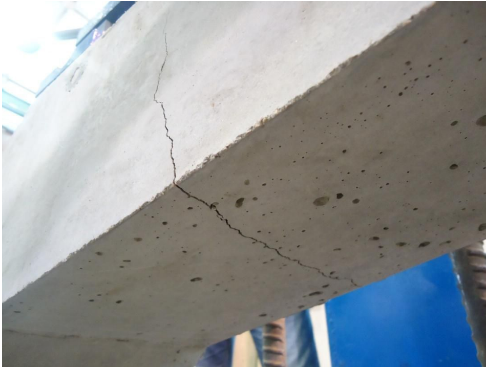
Figura 10.13. Fisura de la sección G tras la descarga.
