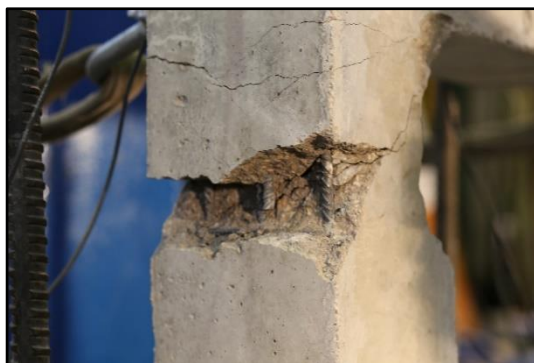
Fig 5.1.1.10 Detalle rotura pilar izquierdo
