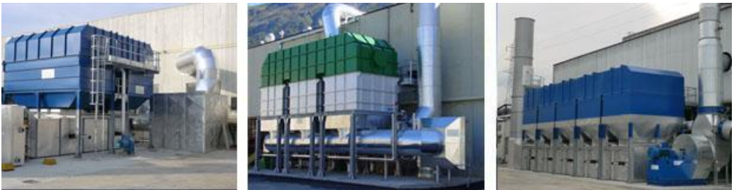
Figura 1.8: Instalación de oxidación térmica regenerativa.
