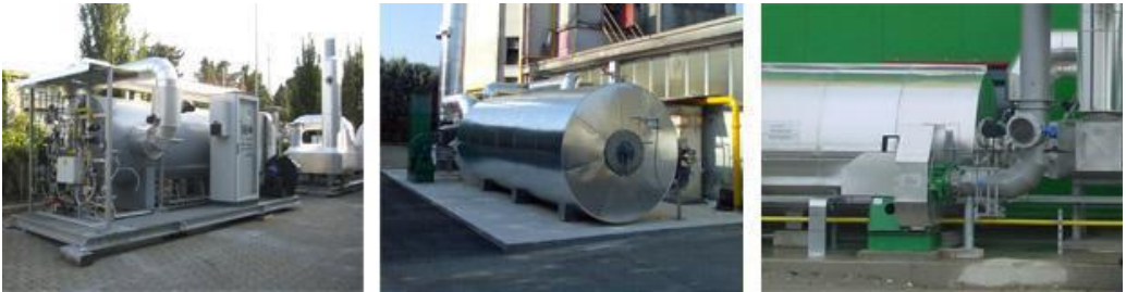
Figura 1.7: Instalación de oxidación térmica recuperativa.
