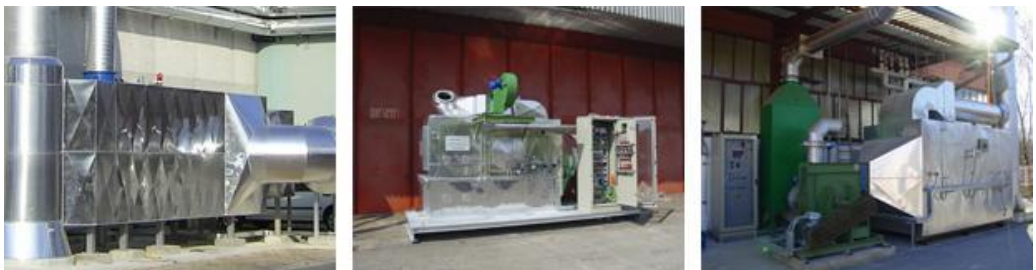
Figura 1.9: Instalación de oxidación catalítica.
