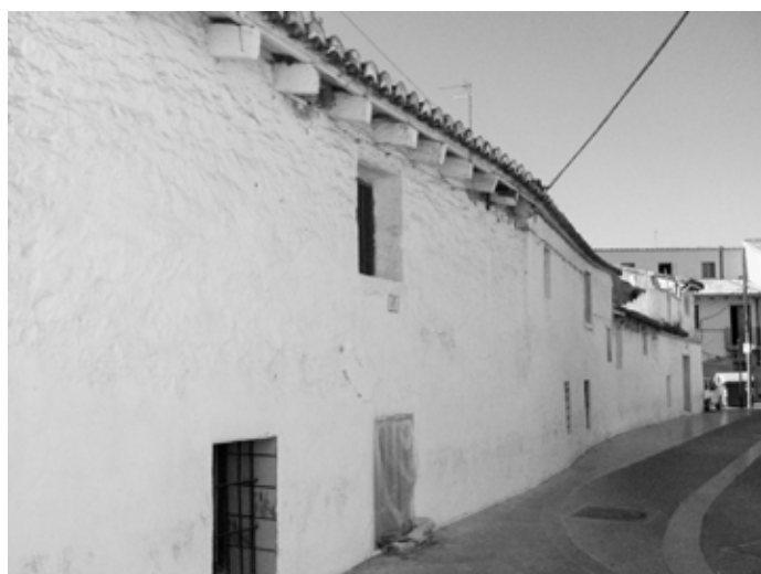
2.44. En la fotografía se puede observar la sinuosidad de la edificación, además de las consecuencias que ha llevado la realización del nuevo perfil de la calle Molino de la Marquesa. El nuevo trazado está al menos a una cota de 70 cm. por encima de la cota original, dejando el conjunto edificatorio hundido, tal y como atestigua la puerta de la imagen, que ha quedado sin utilidad y la ventana que se encuentra a la altura del suelo, siendo testigos mudos del cambio de nivel que había en ese punto.
