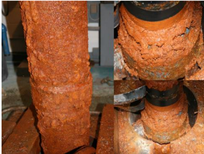
Figura 3. Biofilm en tubería de impulsión y otros elementos del sondeo.
