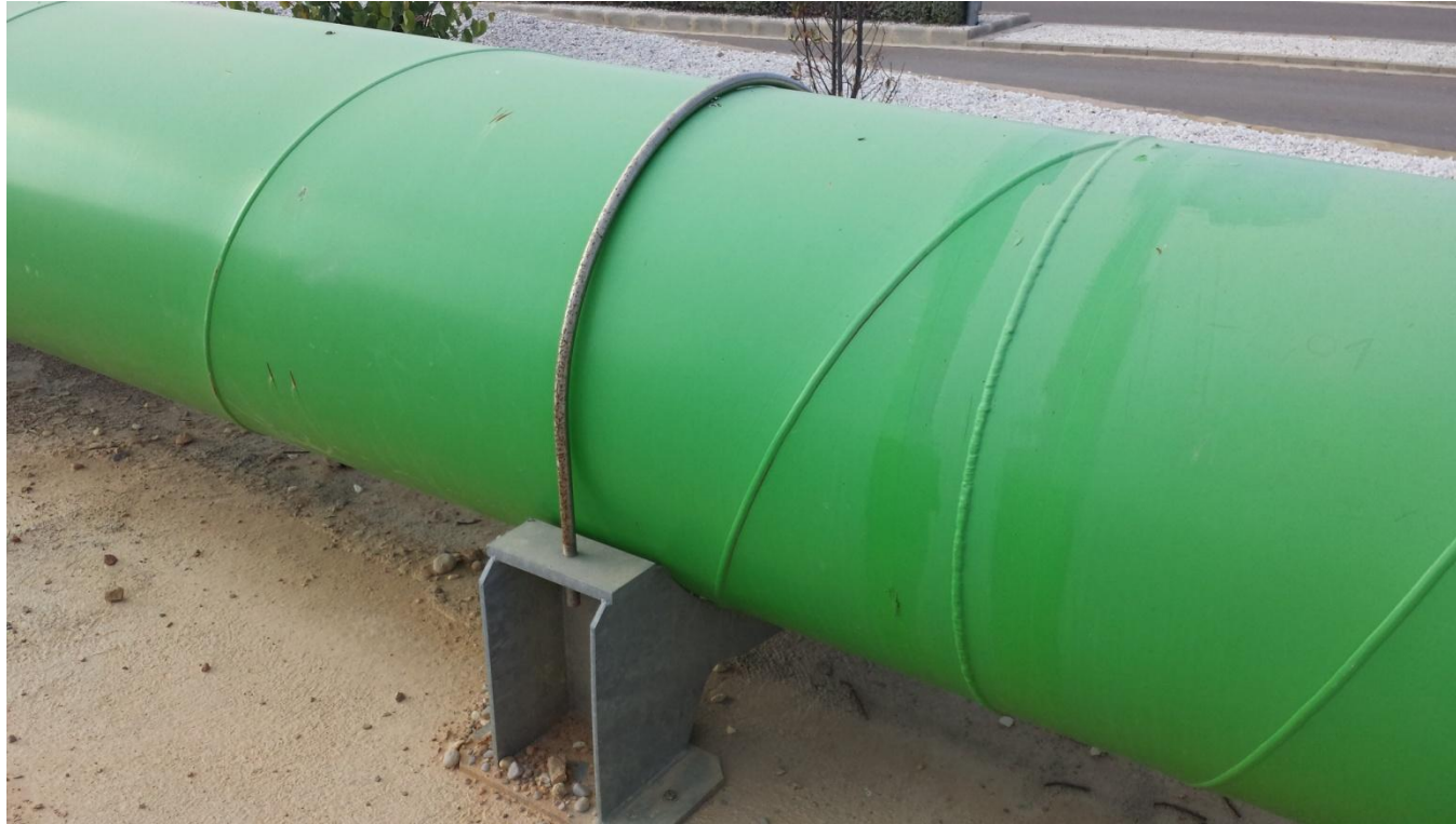
DETALLE VÁLVULA ELECTROMAGNÉTICA DE MARIPOSA
