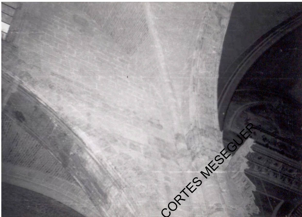
Imagen del archivo de Vicente Minguet de las obras de descubrimiento de la obra gótica, década 1970
