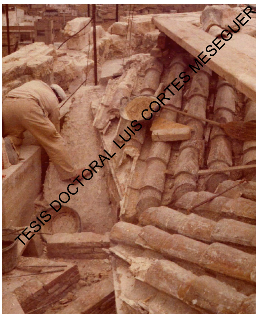
Imagen de los trabajos de restauración de la cubierta del Cimborio. Archivo personal de Vicente Minguet, década de 1970
