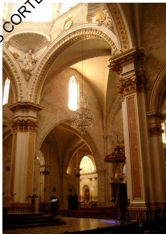
Imagen de los plafones de Buixcarró en los fustes de los pilares del crucero, algunas sustituidas por estuco y pintura. 2013
