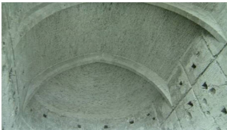
Otro detalle de la bóveda interior de ladrillo y arcos de piedra.
