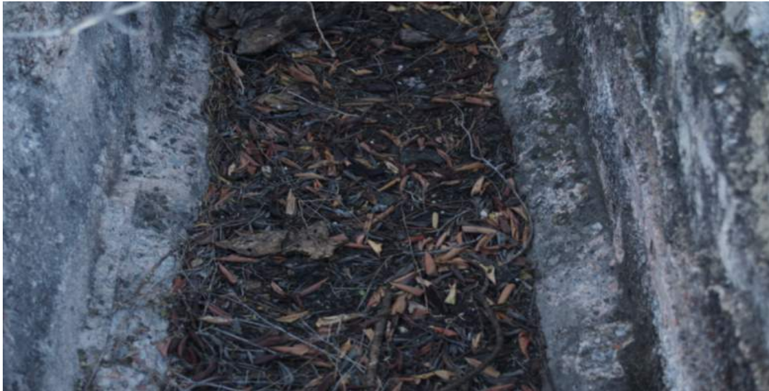
Canal interior del acueducto con caña en lateral en la base del canal
