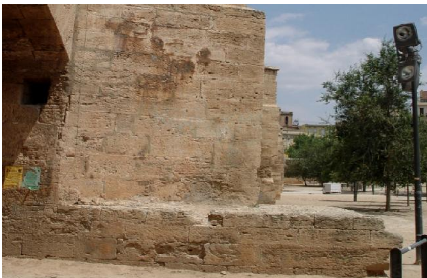
Primera escalera destruida y convertida en tallamar
