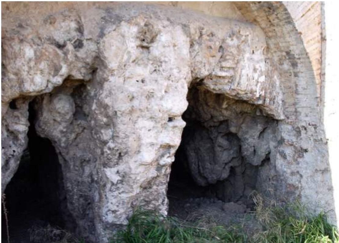
Uno de sus viejos arcos con una “muleta” de piedras mortero para evitar desplome.
