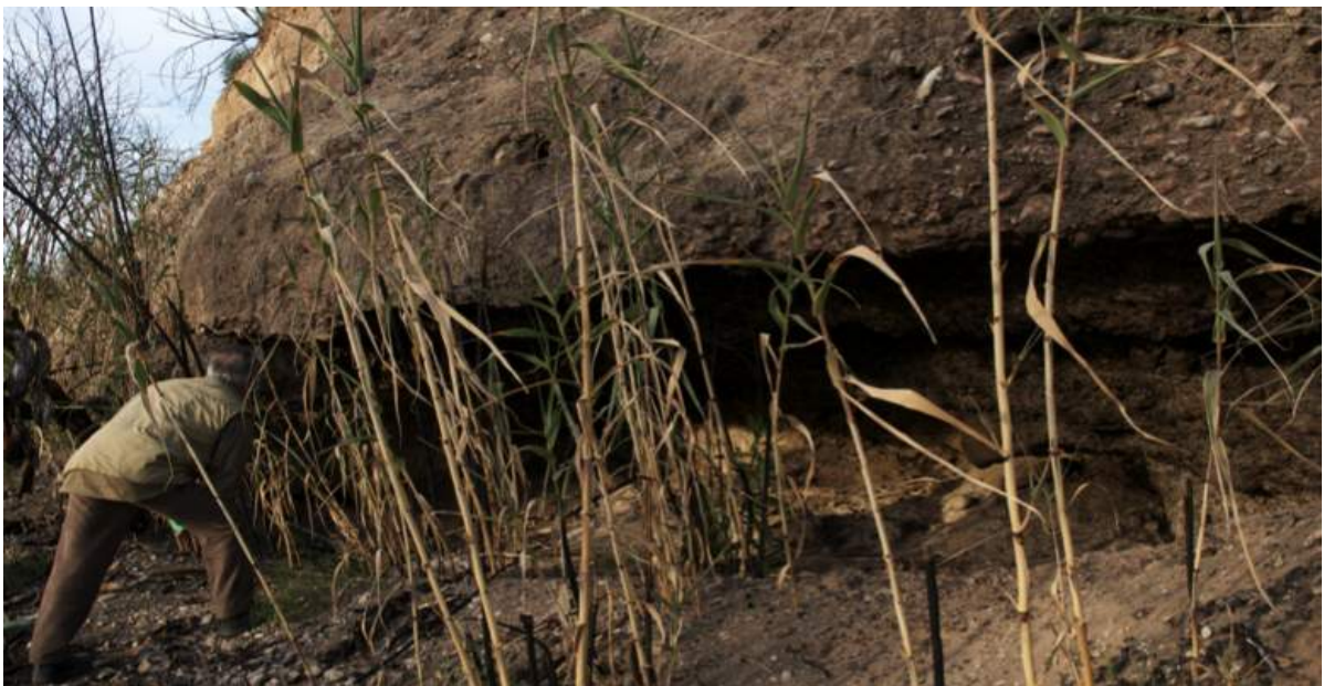
Corredor de grava erosionado por la corriente del agua, bajo estructura romana
