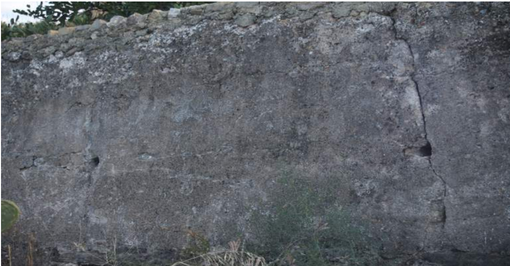
Muro exterior del acueducto con agujeros para unos pequeños andamios de madera
