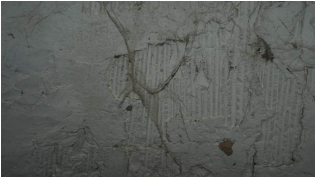
Interior de la bóveda con los restos del encofrado de cañas. Molino Malany
