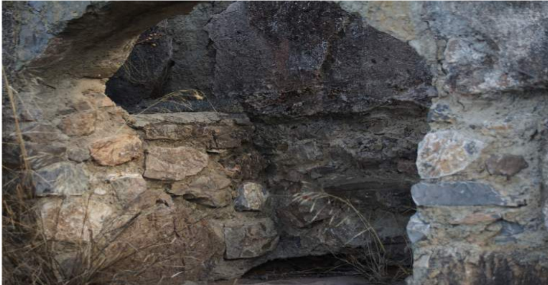
Hueco de desagüe de 1987. Al fondo, parte superior, pared lisa del canal y caña destruida
