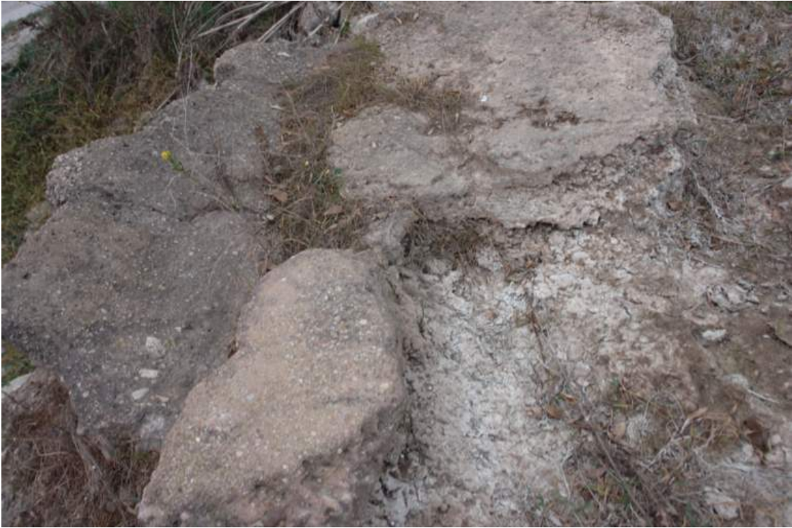
Imagen de la parte del canal del acueducto mejor conservada con el lecho del canal y en la parte izquierda restos de la lechada de hormigón de base del canal (a ambos lados)
