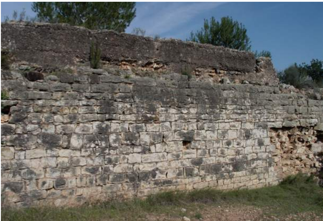
ACUEDUCTO 1. Barranc de Porxinos. Detalle del canal y el paramento de opus quadratum . Riba-roja del Turia (Valencia)
