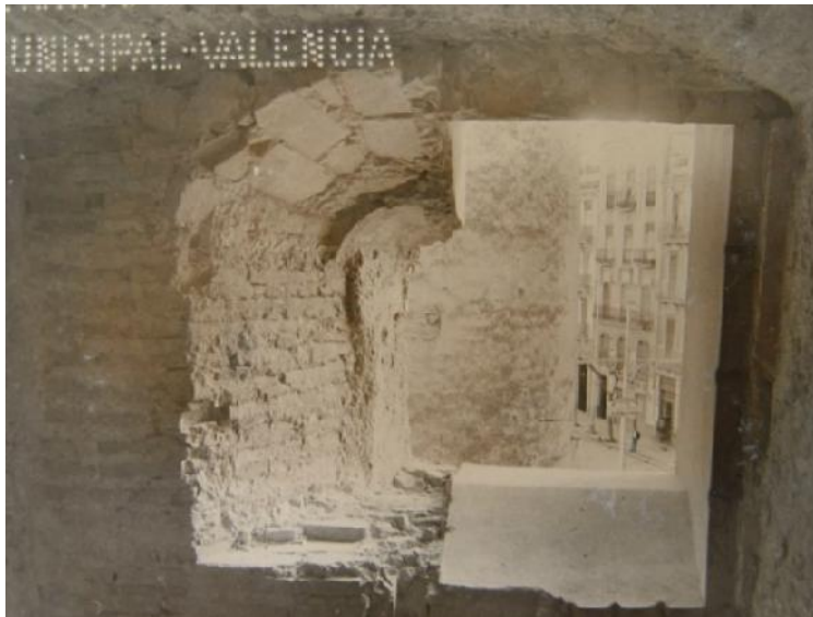
Saetera cortada por ventanal moderno
