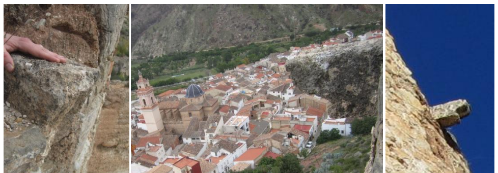
Imágenes 4.25, 4.26 y 4.27. Ménsulas encontradas empotradas en la fábrica de la torre oeste.
