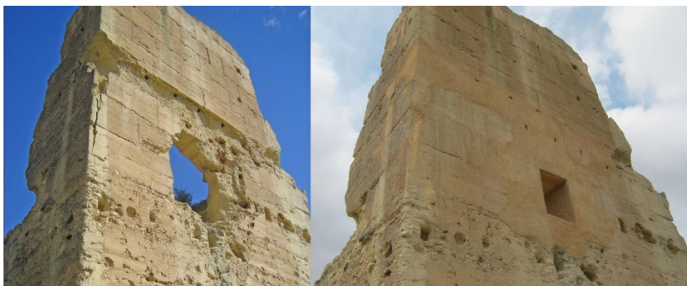
Imagen 3.16.- Fotografía comparativa de la torre antes y después de la intervención de 2011
