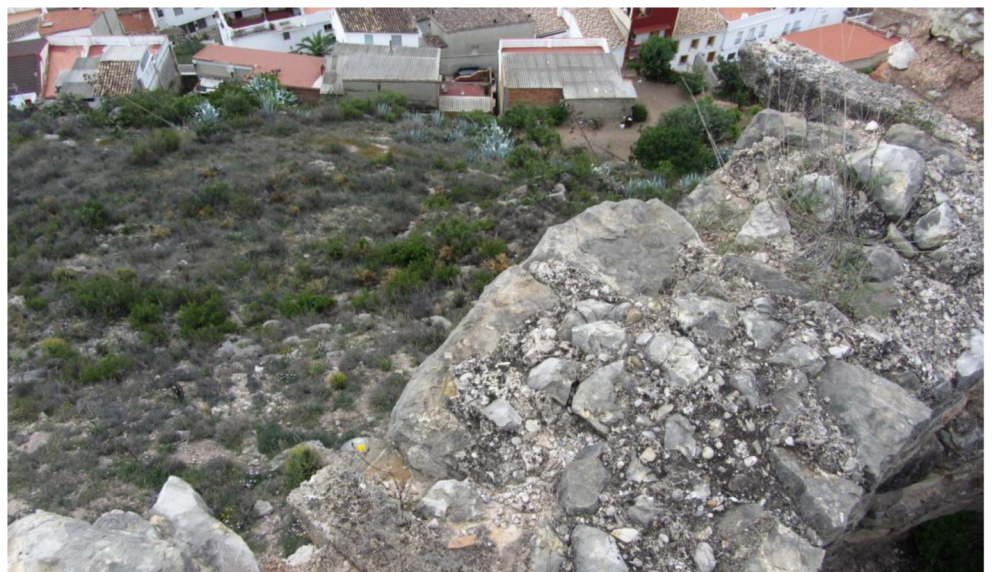
Imágenes 4.34. Restos de los apoyos del matacán, a la altura del cambio e sección de la torre.
