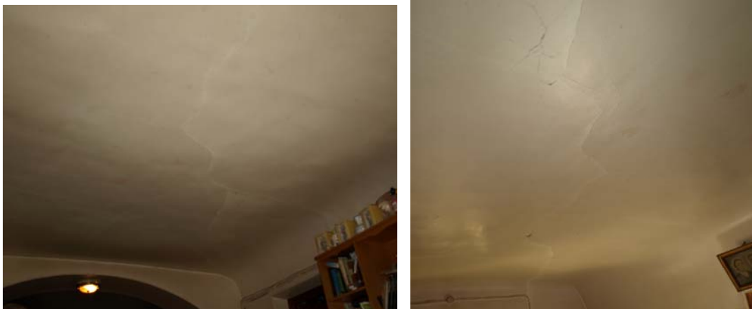
Foto 47: Grieta longitudinal en bóveda.
