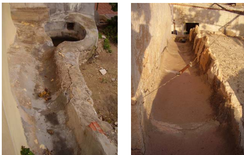
Foto 21: Canalizaciones de agua de cubierta.
