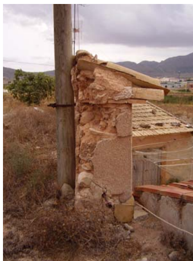
Foto 54: Apoyo de red eléctrica empotrado en cubierta de cueva.
