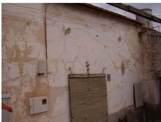
Foto 52: Deterioro y pérdida del acabado de pintura y manchas en la superficie.
