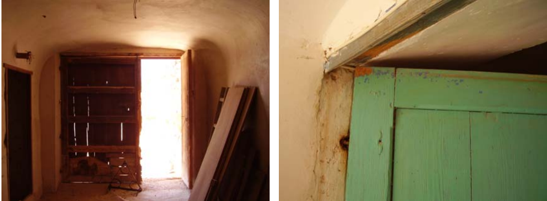
Foto 53: Deterioro y pérdida del acabado de pintura y manchas en la superficie.
