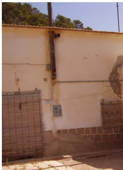
Foto 56: Apoyo de red eléctrica anclado a fachada.
