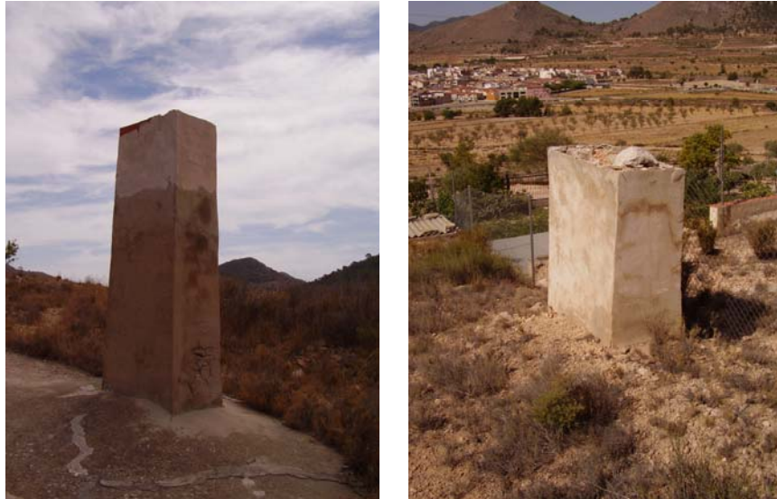
Foto 57: Chimeneas sin remates.
