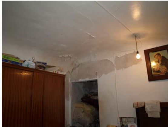
Foto 44: Filtración por cubierta acabada con mortero de cemento.
