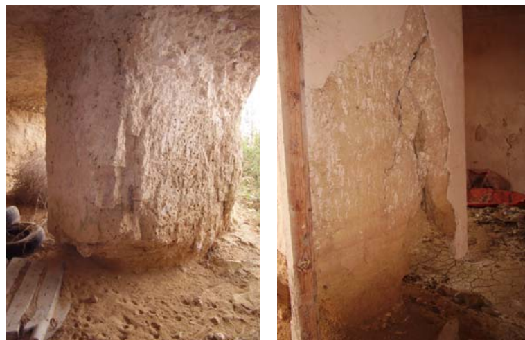
Foto 50: Erosión y descomposición de muros (terreno natural).
