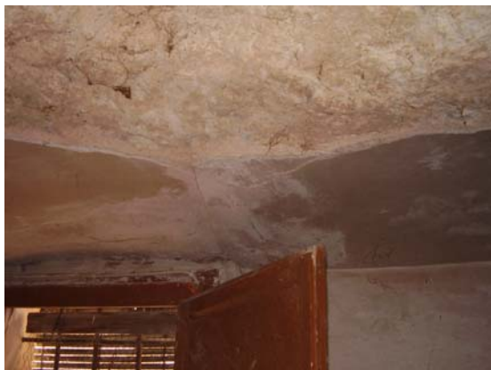
Foto 51: Desprendimiento de revestimiento por filtración de agua.
