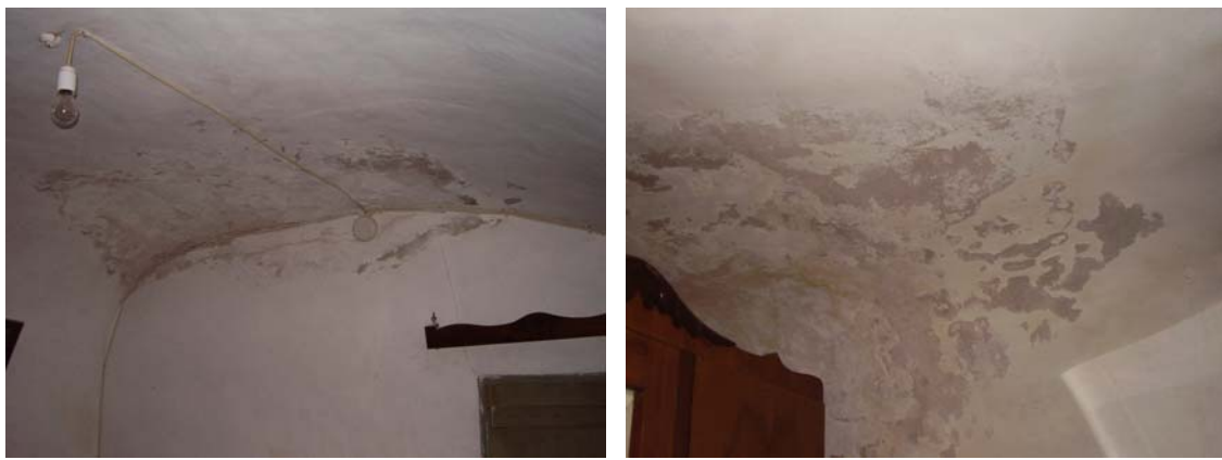
Foto 46: Filtraciones por encuentro entre cubierta y antepecho.
