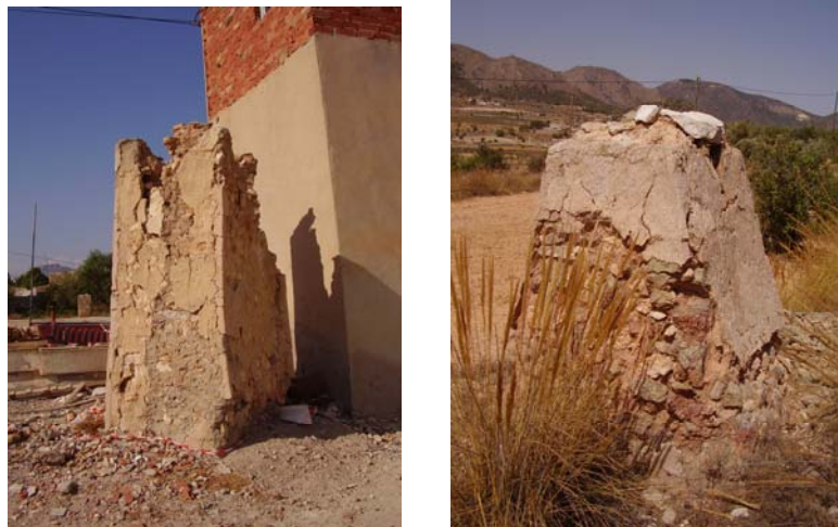
Foto 49: Erosión de las juntas de las fábricas y desmoronamiento de antepechos y chimeneas.
