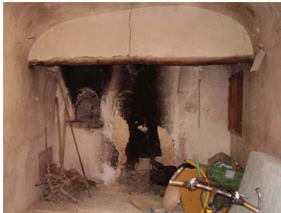
Foto 18: Configuración de la chimenea en el interior.
