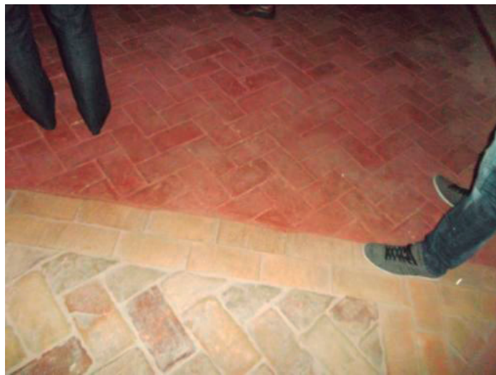
Figura 33. Imagen de los ladrillos antiguos del suelos, notándose la diferencia de los colocados posteriormente. 2014. M a Nieves Pujol.
