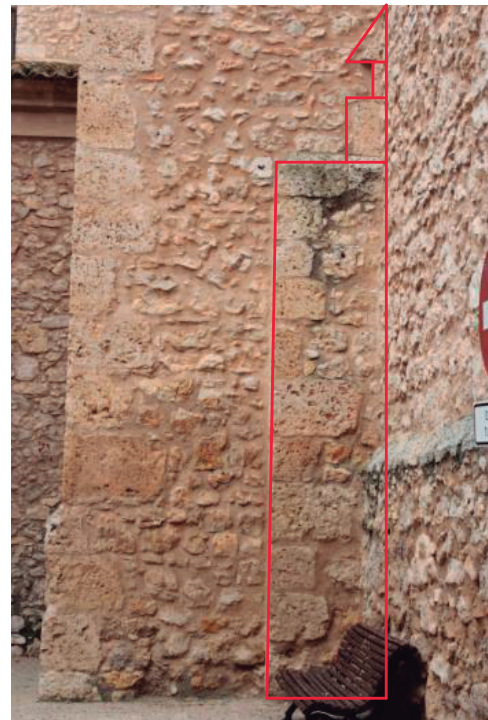
Figura 24. Imagen de restos de la antigua portada en la fachada. 2014. M a Nieves Pujol
