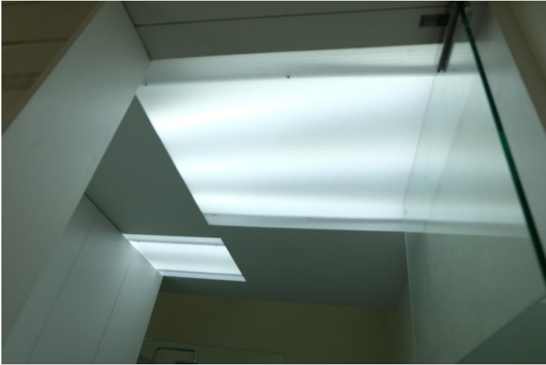
Il·lustració 42. Foto Luminàries policarbonat, registrables per a màquines d'aire condicionat. 2014. Documentació pròpia.
