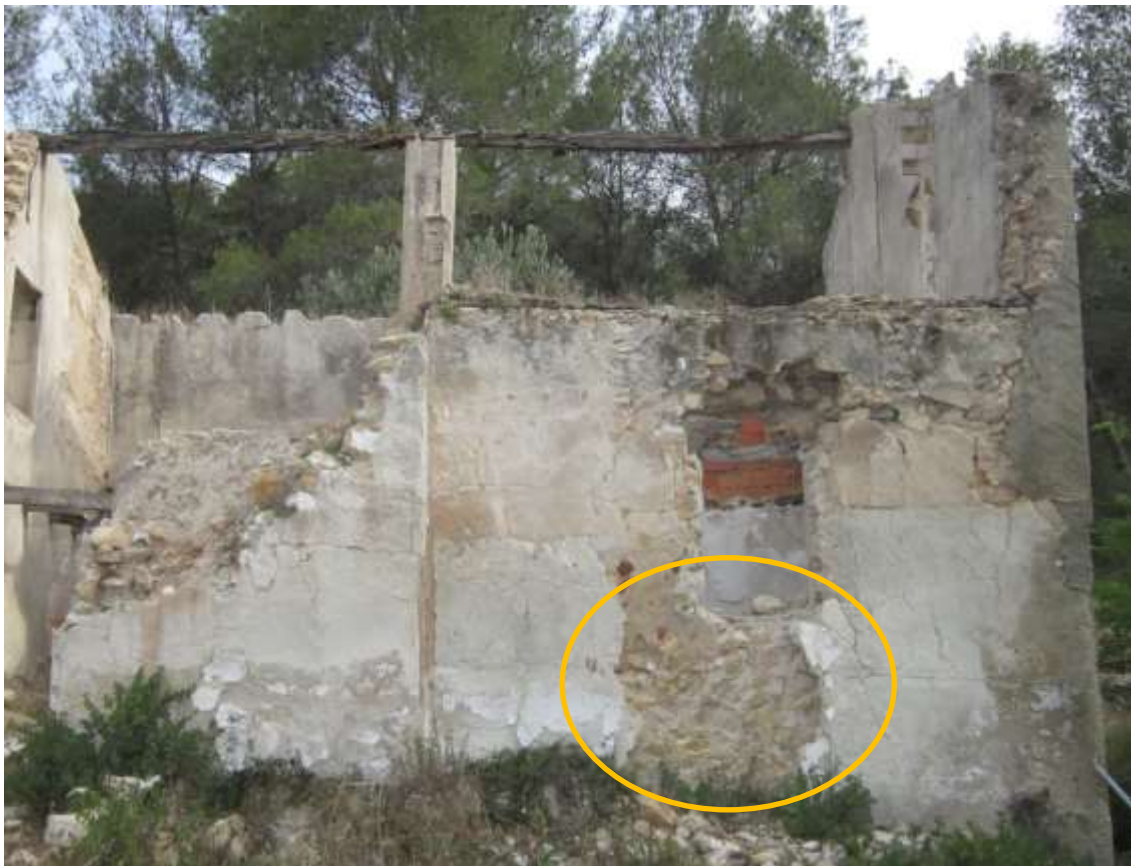
Figura 8: Desprendimiento en el paramento de la vivienda del ermitaño.
