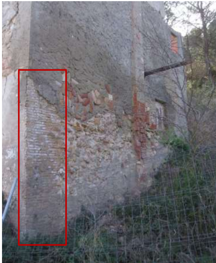
Figura 11: Refuerzo de ladrillo en esquina de muro de mampostería. Esquina perteneciente a la vivienda del ermitaño. Alzado Este.
