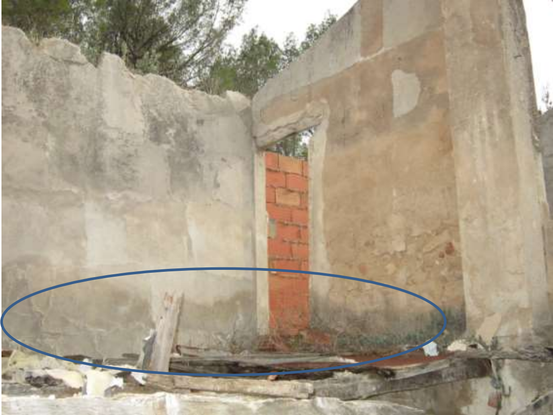
Figura 4: Humedades en planta primera
