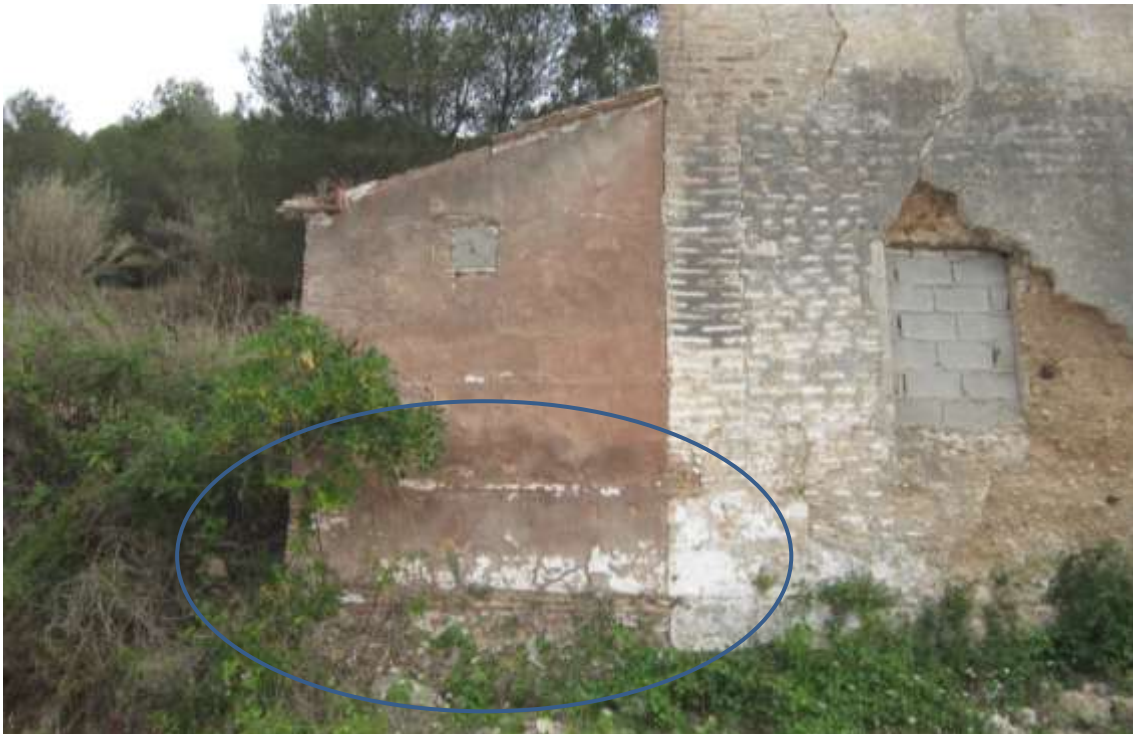
Figura 3: Manchas de humedad en el paramento exterior
