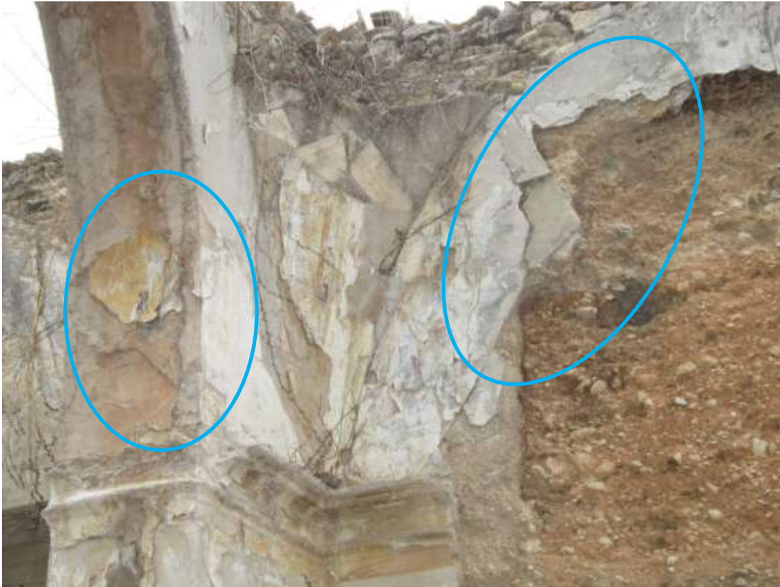
Figura 9: Desconchados y desprendimientos de material en el interior de la ermita.
