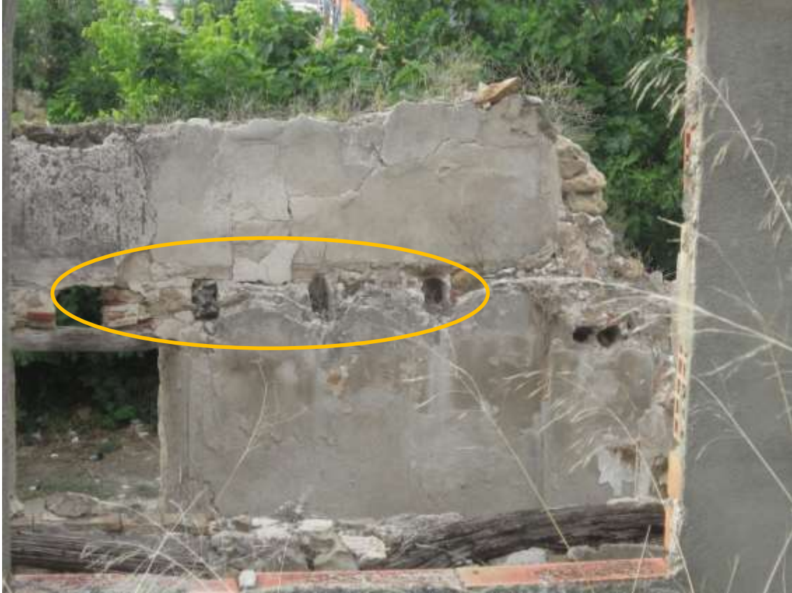
Figura 22: Huecos en el muro de mampostería.
