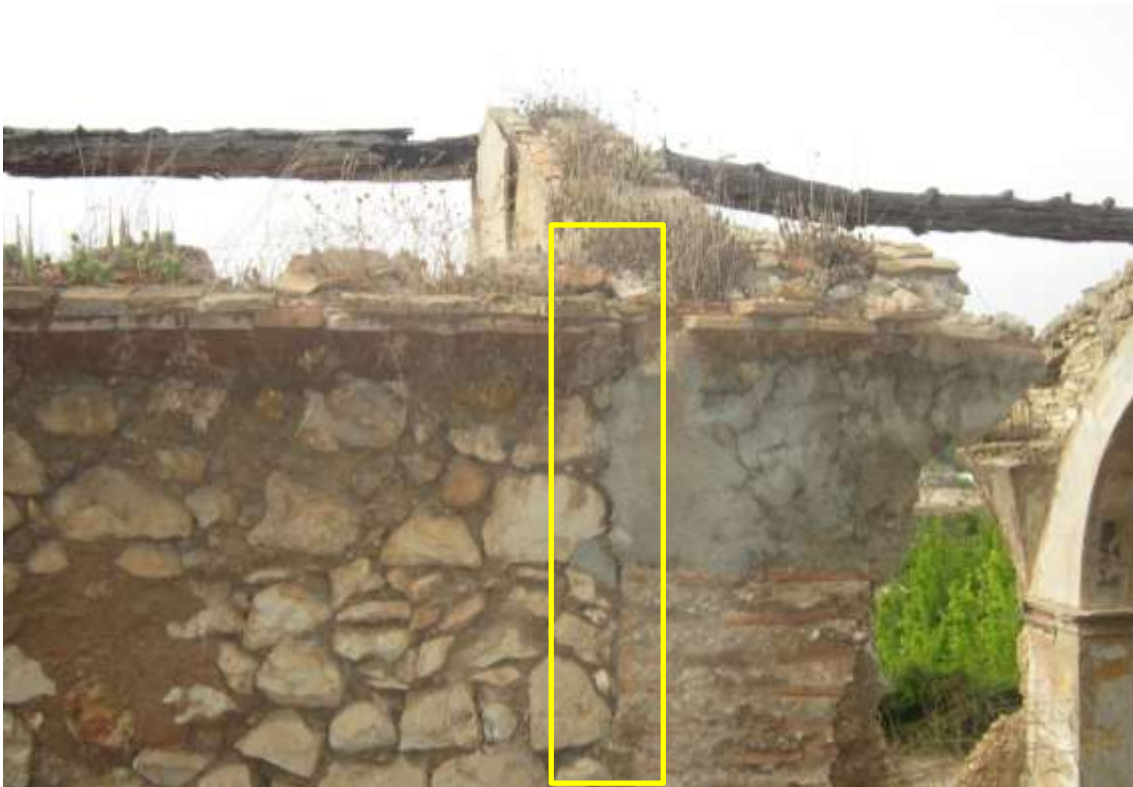
Figura 1: Grieta en la unión del pilar con el muro.
