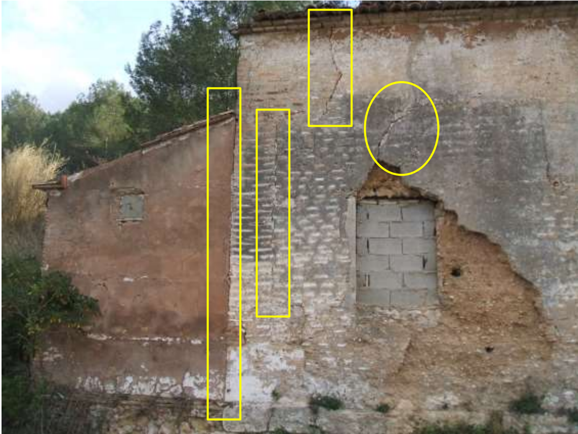
Figura 2: Grietas y fisuras en la fachada principal
