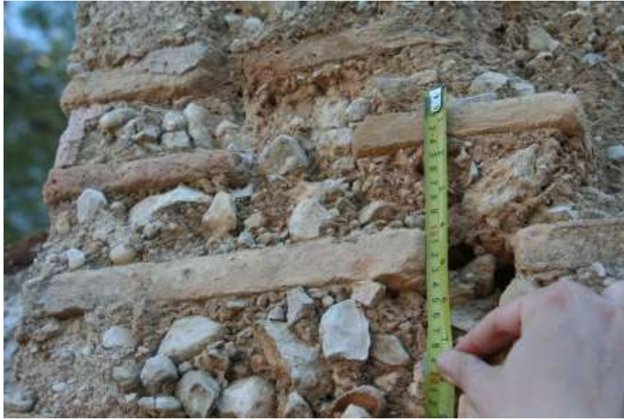
Figura 9: Detalle de la separación de los ladrillos. Fotografía de L. Cortés Meseguer.
