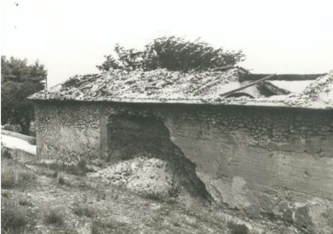
Figura 23: Vista de la cubierta en deterioro. 1983. (Imagen cedida por AMX Rg: 1491/3)
