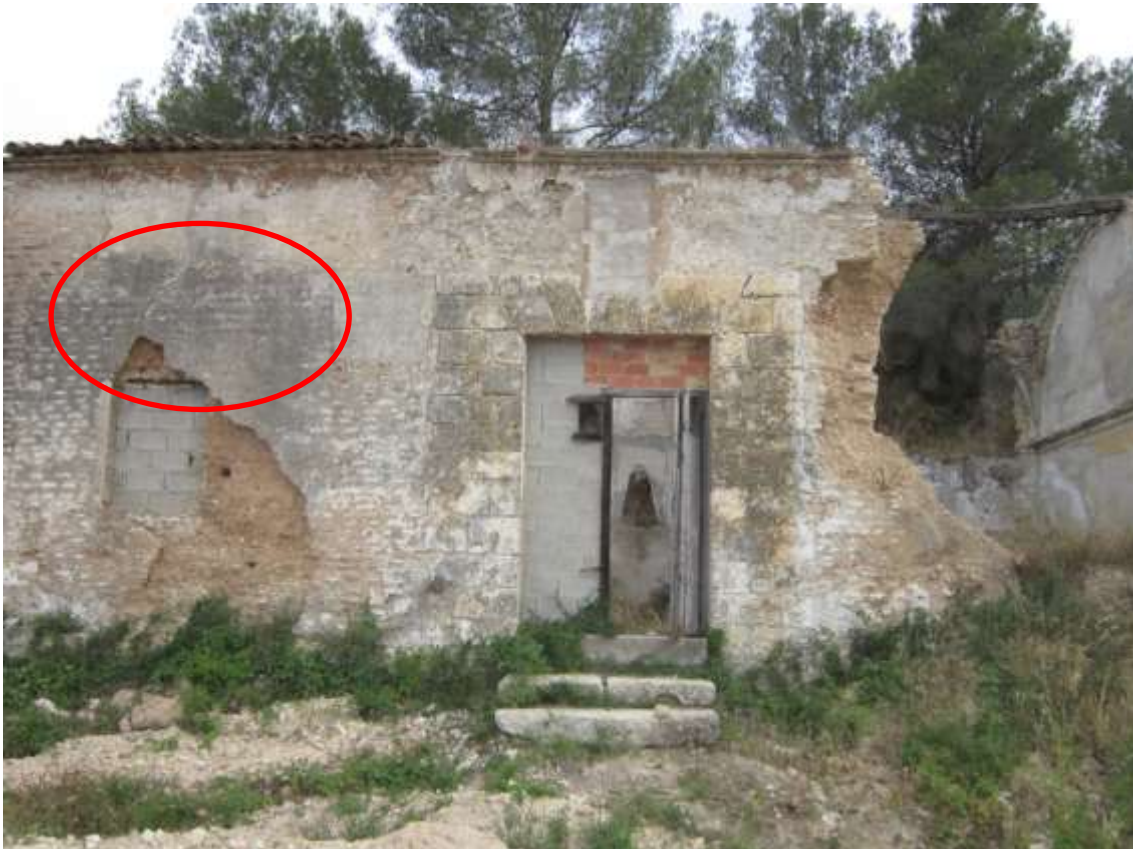
Figura 10: Ennegrecimiento en fachada
