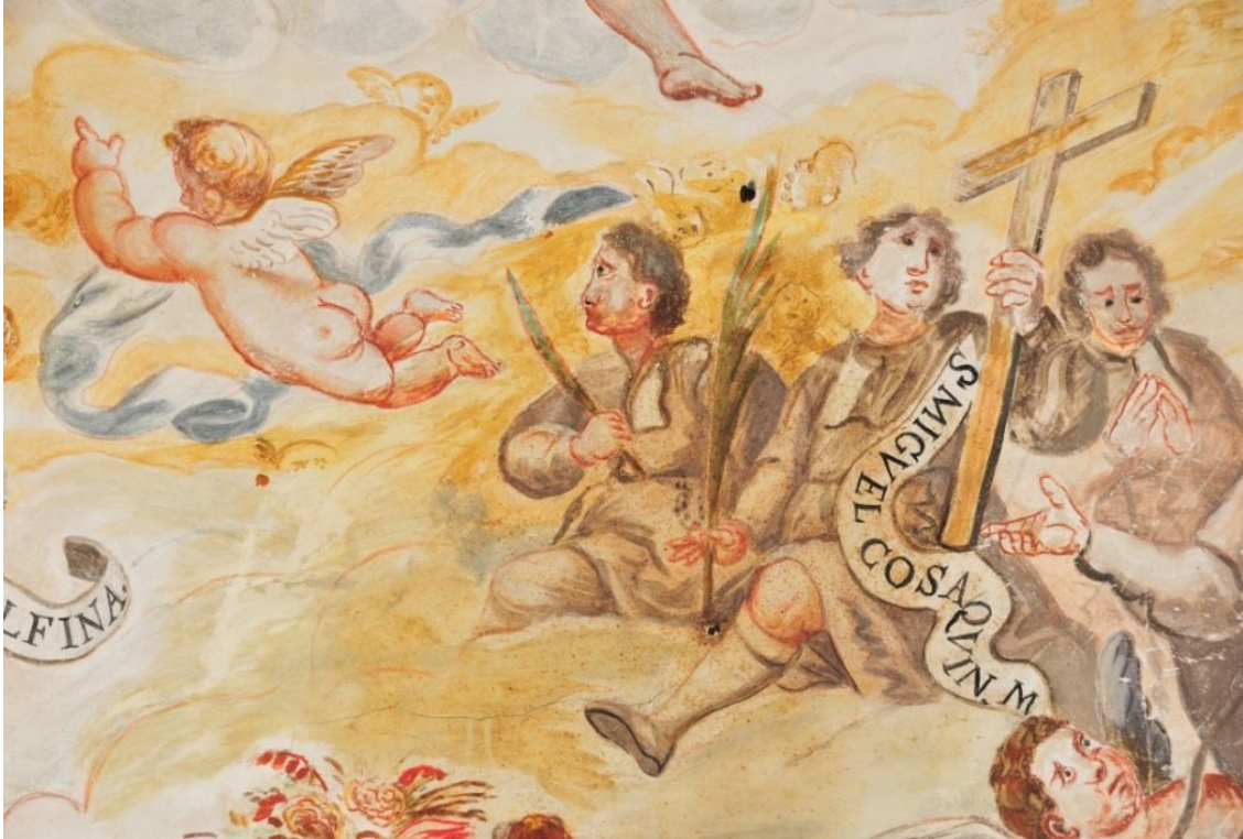
Imagen 49. Área afectada por la humedad
