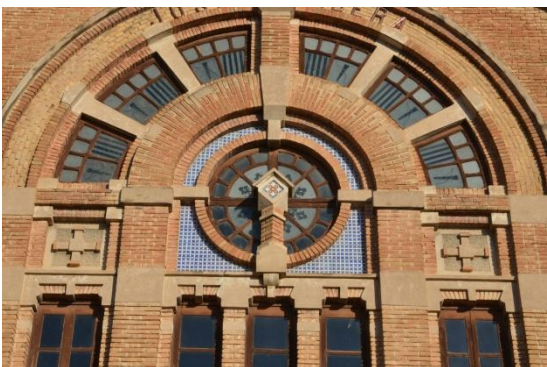
Imagen 3.19:Conjunto de ventanas de la fachada de la nave principal recayente en la calle "Joanot Martorell".
