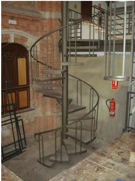
Imagen 3.23: Escalera de caracol para acceso a cuartos de instalaciones.
