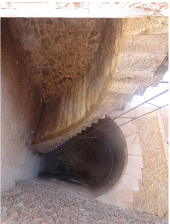
① HUMEDAD POR CONDENSACIÓN
