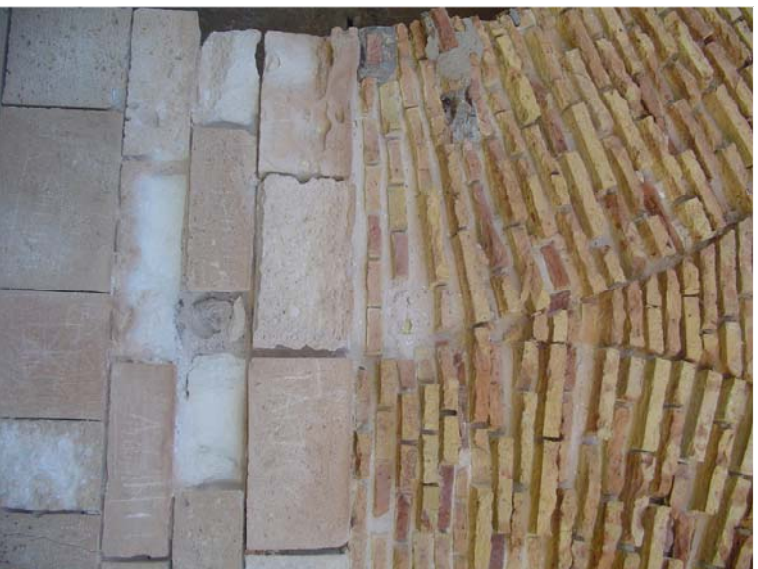
④ DESPRENDIMIENTO DE LADRILLO Y PIEDRA
