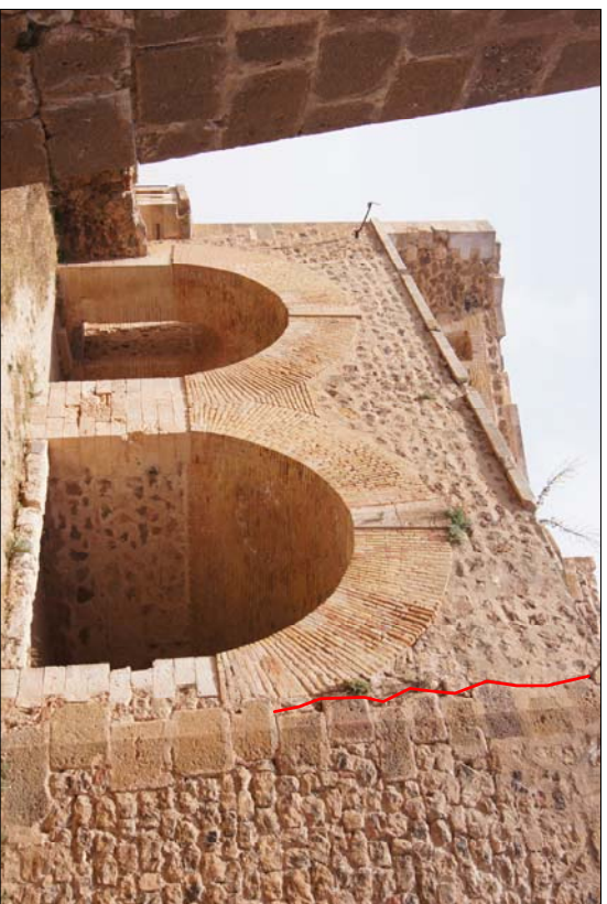
① FISURA EN MAMPOSTERIA
