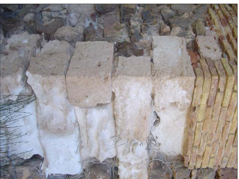
③ EROSION DE LA SILLERIA
