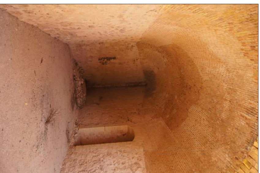
③ LAES SALES EN EL TECHO DE LA BOVEDA
