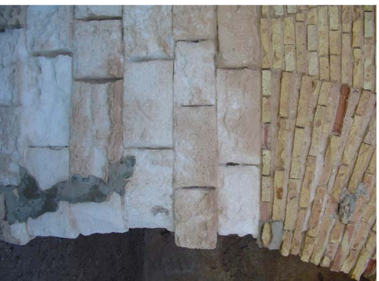
⑥ DESPRENDIMIENTO DE LADRILLO Y PIEDRA
