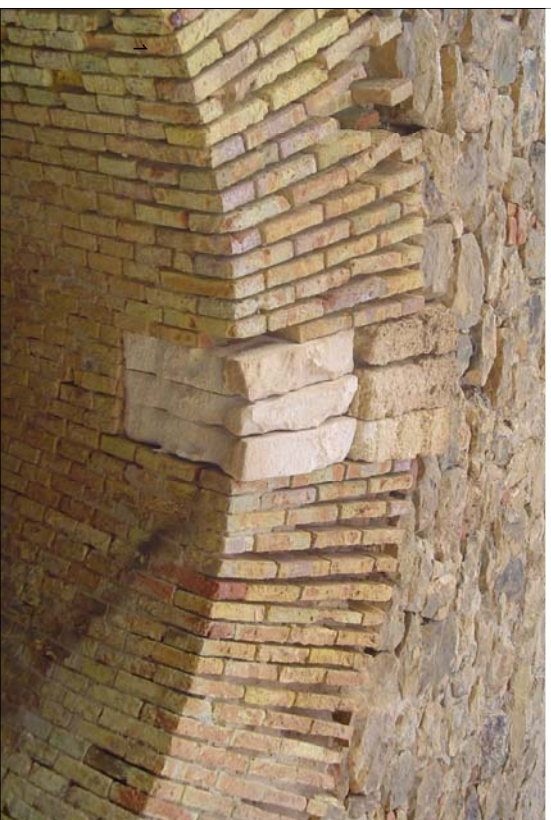
① EROSION DE LA SILLERIA
