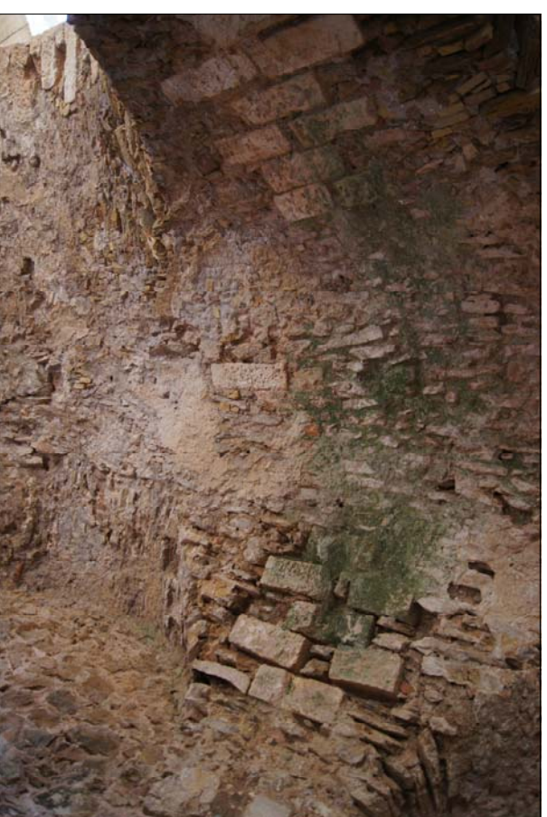
④ HONGOS EN LA BÓVEDA DE ENTRADA
