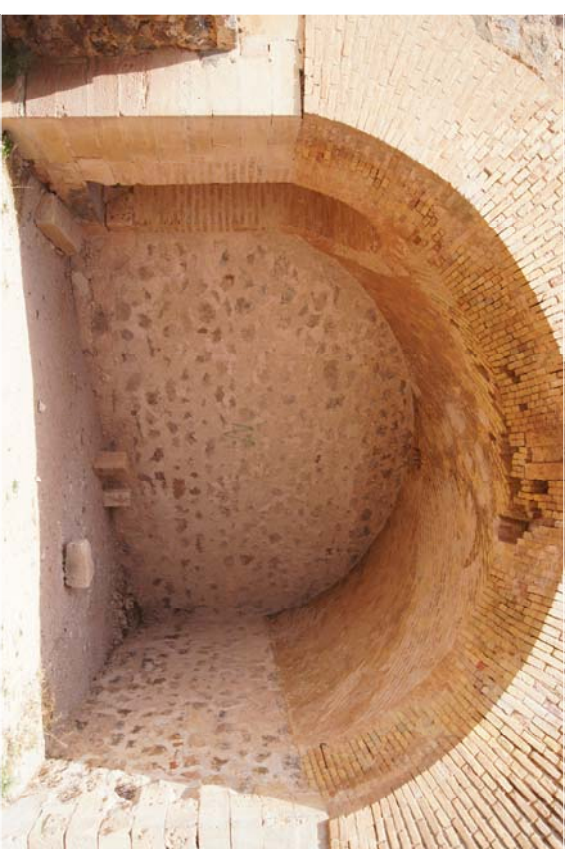
② HUMEDAD POR CAPILARIDAD
