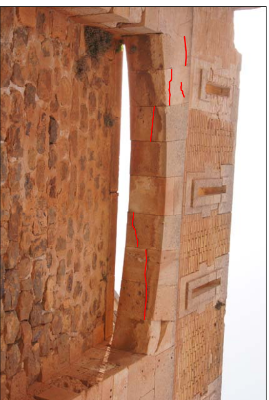
② GRIETAS EN LA SILLERIA
