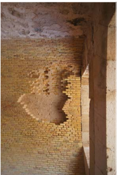
① DESPRENDIMIENTO DE LADRILLO
