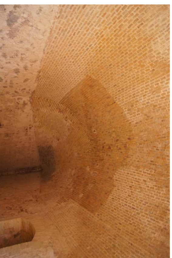
④ HUMEDAD DE INFILTRACIÓN Y ABSORCIÓN
