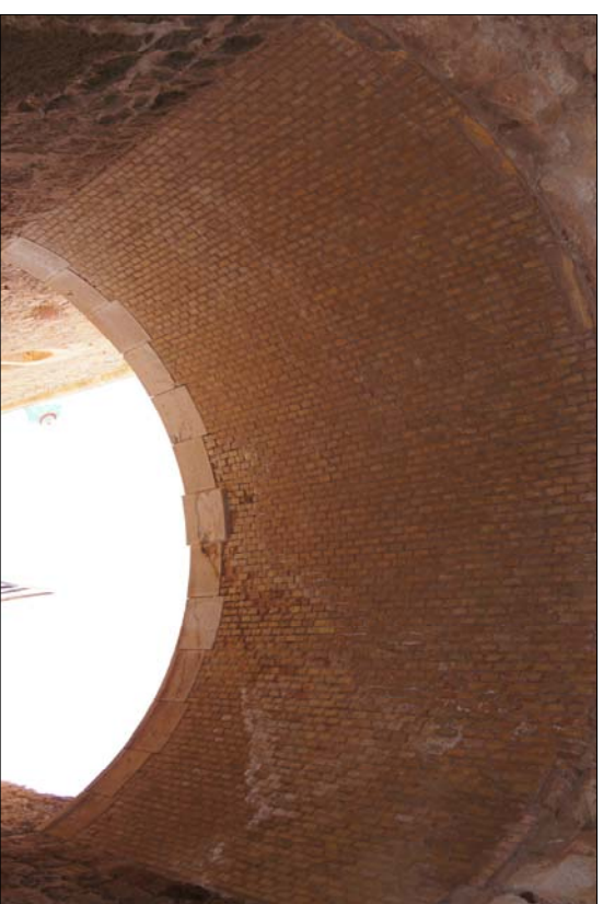
② LAES SALES EN EL TECHO DE LA BOVEDA
