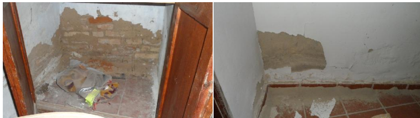
Ilustración 47. Desprendimientos puntuales en muros interiores. Fuente: propia autora
