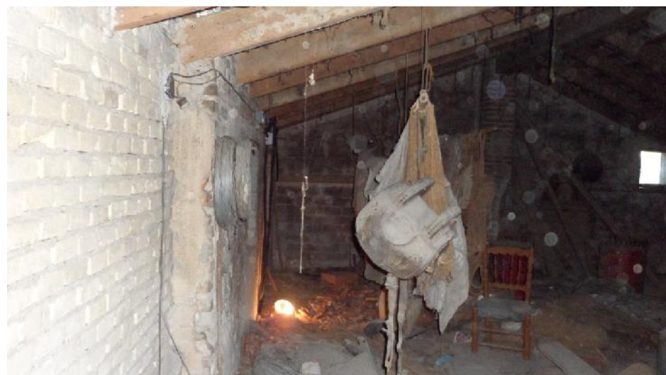
Ilustración 33. Cambio de espesor en el muro de carga
