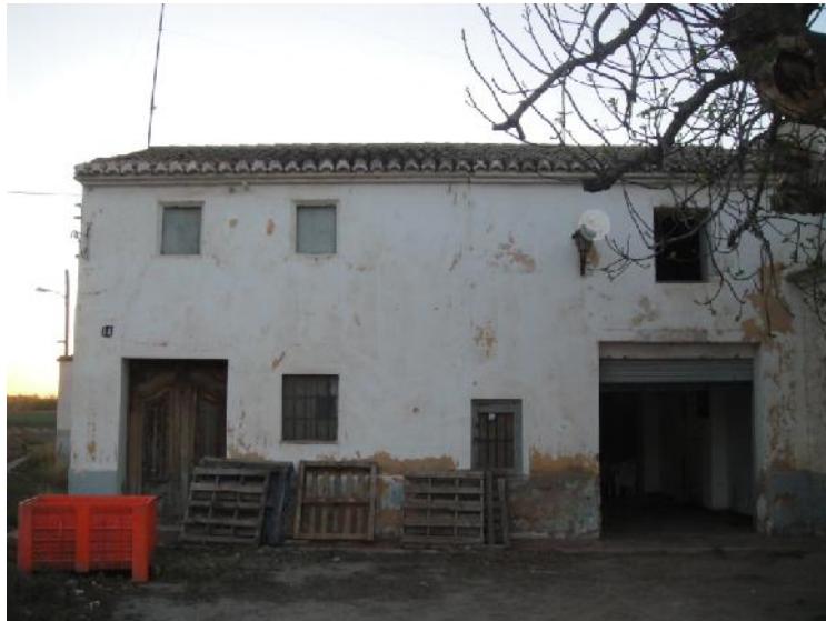
Ilustración 46. Fachada principal con presencia de desprendimiento y mancha del revestimiento. Fuente: propia autora
