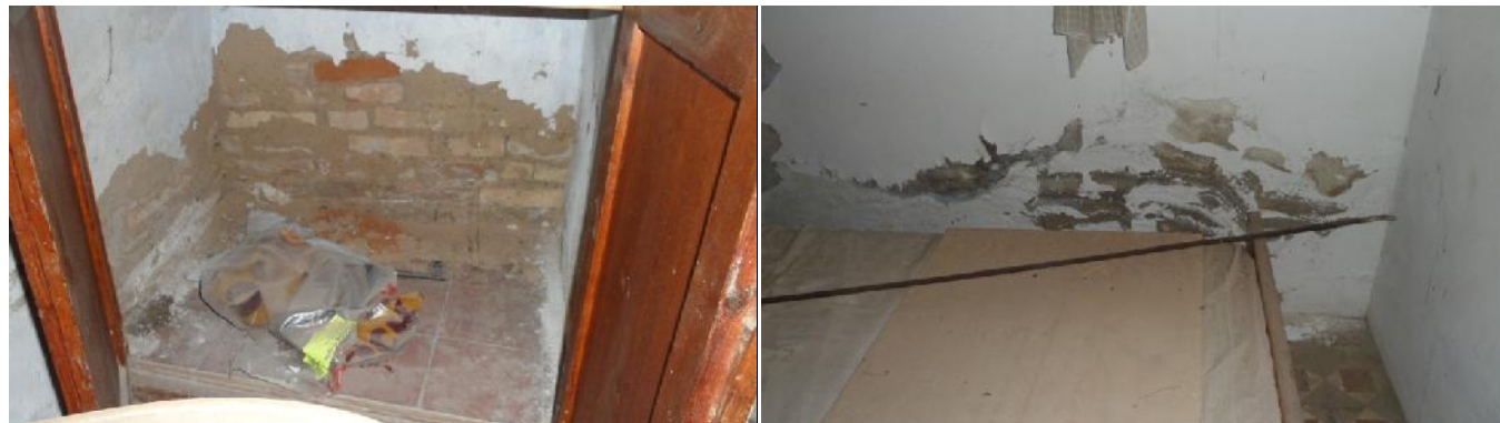
Ilustración 51. Desprendimiento del revestimiento dormitorio 3. Manchas y desconchado muro de dormitorio 1. Fuente: propia autora
