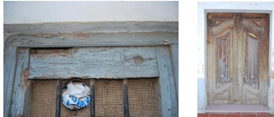
Ilustración 59. Presencia de xilófagos y rotura de algunas partes de las carpinterías. Año 2014. Fuente: propia autora
