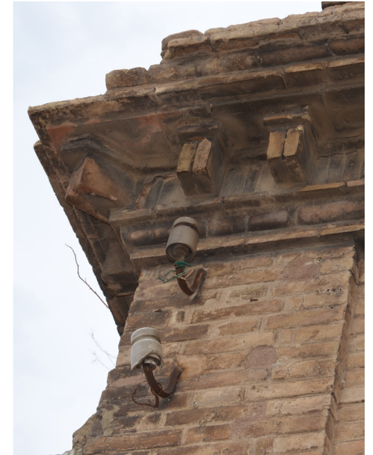
Imagen XI-21. Elemento auxiliar para la instalación eléctrica. Fuente: Propia
