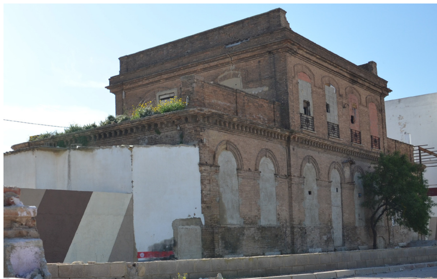
Imagen XI-14. Antepecho de cubierta desaparecido de la fachada Oeste (calle Cuatretonda), y de la terraza del cuerpo lateral del testero Norte. Fuente: Propia
