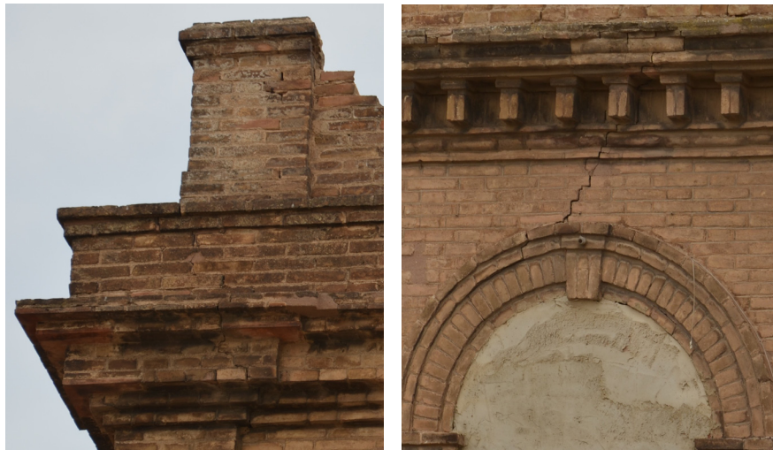
Imágenes XI-15 y 16. Fisuras y grietas en la parte superior del cuerpo central de cubierta, y encima de la clave del cuerpo lateral en la Fachada calle Cuatretonda. Fuente: Propia
