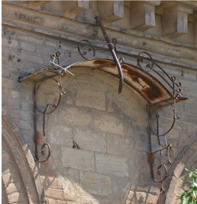
Imagen XI-19. Protección metálica de reloj. Fuente: Propia
