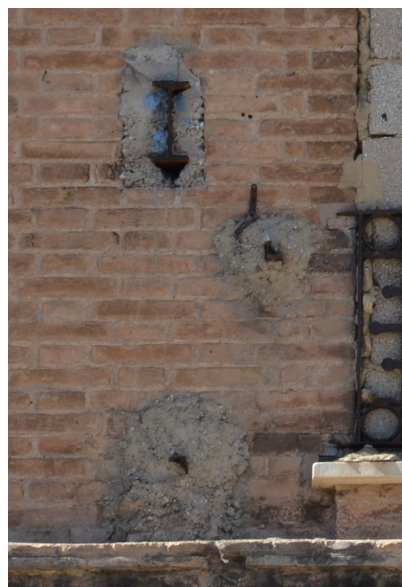
Imagen XI-13. Perfiles metálicos anclados en la fachada, con mortero de cemento. Fachada Este (calle Mayor de Nazaret). Fuente: Propia
