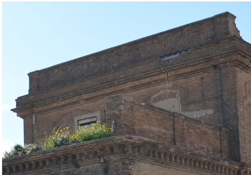
Imágenes XI-17. Grietas en la parte superior del antepecho y esquina del cuerpo central de la fachada Norte. Fuente: Propia
