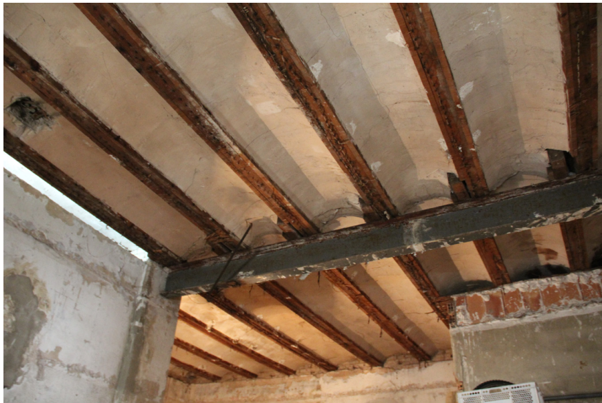
Imágenes IX-121 y 122. Interior de la estación de NAZARET. Detalle de la estructura del forjado. Fuente: Estudio de arquitectura Singularq.
