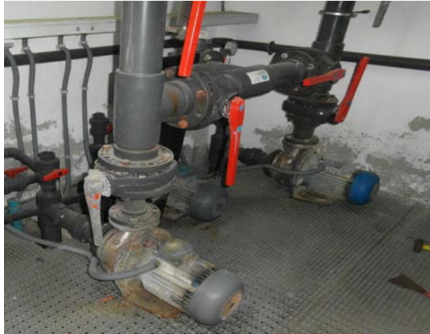
Figura 4. Sistema de bombeo.
