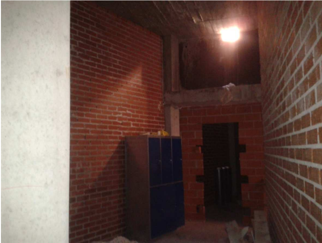
FOTO 8: Vista interior de curto de motores y CGBT
