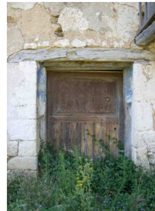
Fig. 9.4-9 Puerta de acceso del Mas de Carlos. En las jambas de sillería en numerosos casos se pueden observar marcas en los sillares de cruces.
