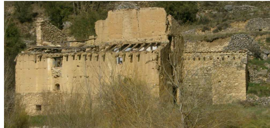
Fig. 9.4-8 Molí Lluch, Tapia calicostrada en la esquina derecha del muro de primera línea se observan maderas en diferentes tapiadas y direcciones para el cosido de las esquinas
