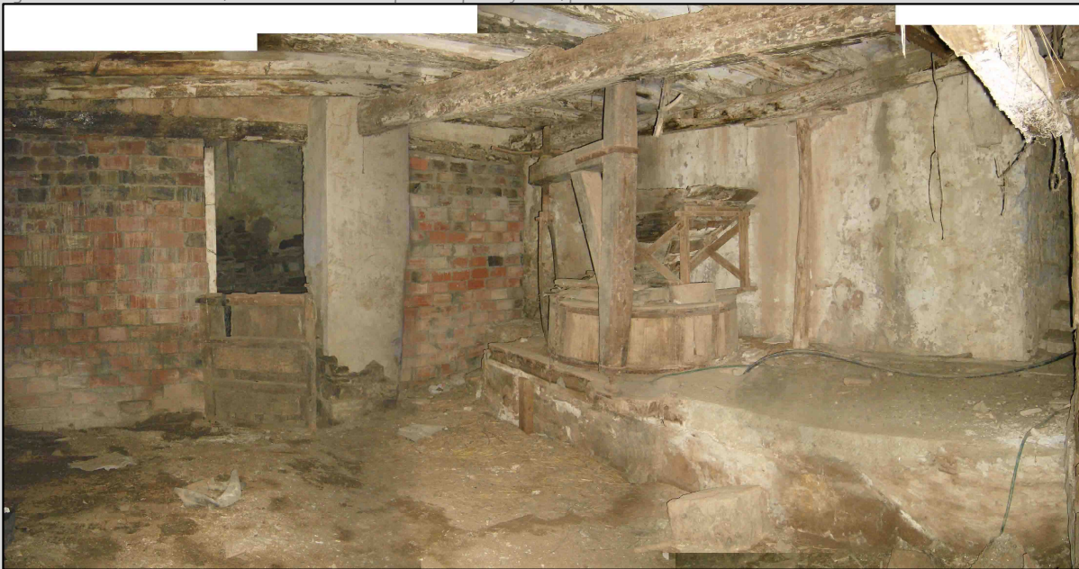
Fig. 12 Vista sala de molienda desde la puerta de vivienda, al fondo establos
