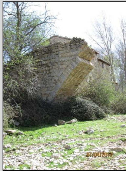
Fig. 5 Restos del puente arranque bóveda
