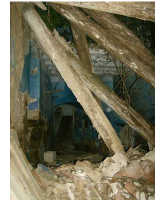
Fig. 9.4-42 Desplome de forjado Molí d'Adell.
