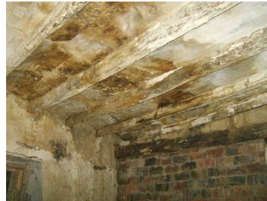
Fig. 9.4-41 Pudrición por humedades Molí d'Adell.
