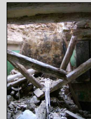
Fig. 20 Colapso de forjado vivienda
