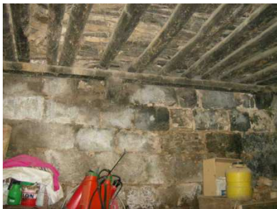
Fig. 9.4-39 Forjado de rollizos y entablado de madera sobre jácena apoyada en canecillos. Molí del Randero.
