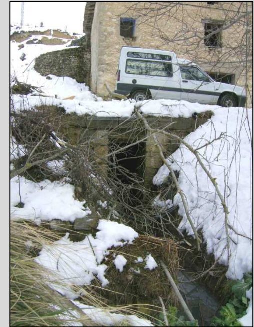
Fig. 17 Desagüe del cárcavo.
