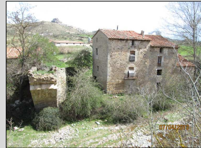
Fig. 6 Vista frontal restos del puente
