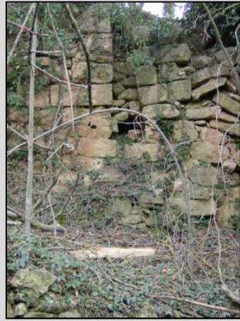
Fig. 12 Testelladó (aliviadero balsa)
