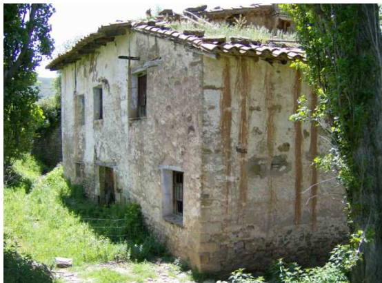
Fig. 9.4-51 Cubierta del Molí Roio, sucia con vegetación. En el interior ya han aparecido goteras.
