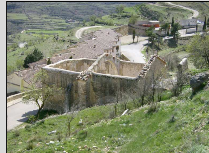
Fig. 6 Vista restos de la cubierta.
