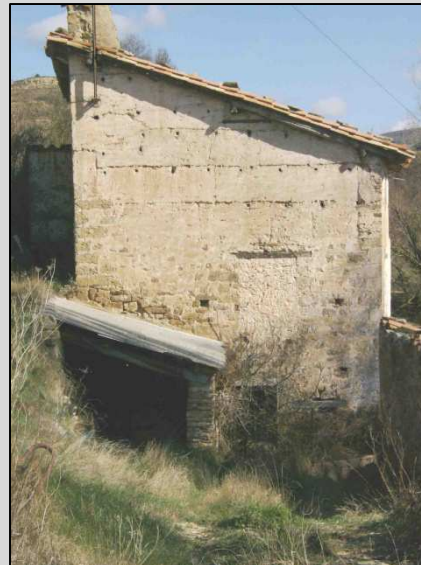
Fig. 6 Fachada Suroeste y tapiadas en planta desván
