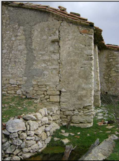
Fig. 13 Junta en recrecido de muro
