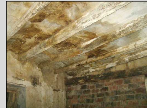
Fig. 19 Humedades por colapso de cubierta
