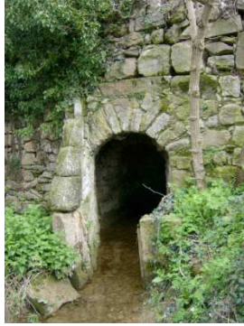
Fig. 6.1.4.4-18 Desembocadura de la acequia en la balsa del antiguo Moli de Zurita.
