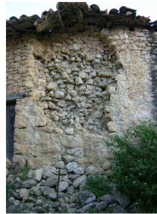
Fig. 9.4-1 Derrumbe de la hoja exterior del muro.
