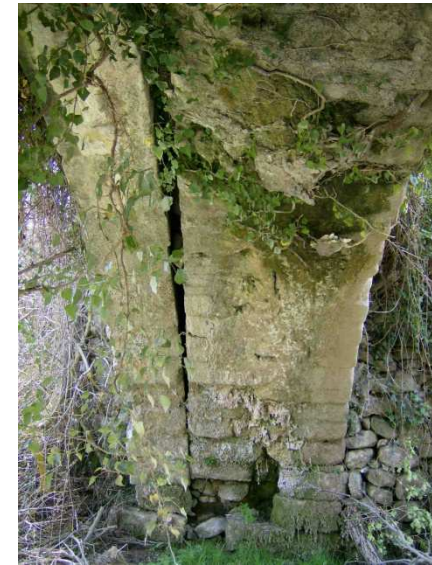
Fig. 6.1.4.4-15 Posible ampliación del acueducto y fisura por falta de traba entre los arcos.
