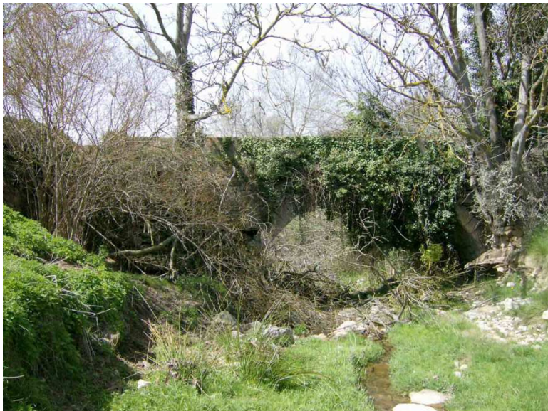
Fig. 6.1.4.4-13 Vista general del acueducto de la acequia del Moli dels Capellans a su paso por el Barranc de la Penella, vista desde aguas arriba del acueducto.
