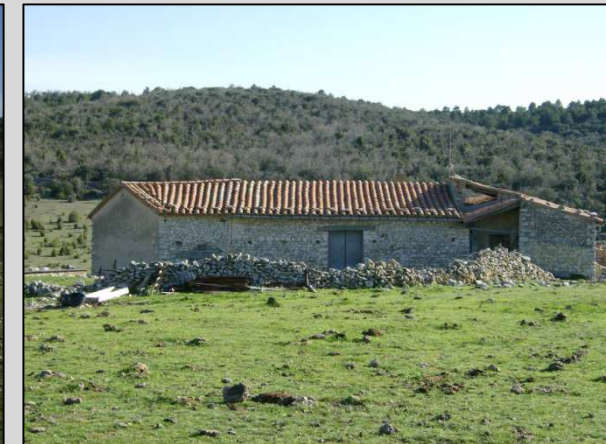
Fig. 9 Vista de la fachada Norte, era y edificios perpendiculares al cuerpo principal
