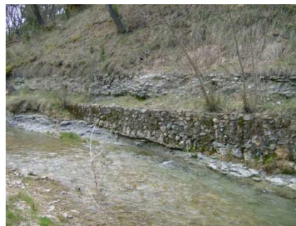
Fig. 6.1.4.4-8 Acequia Molí Flares, muro de mampostería para la creación de la acequia.
