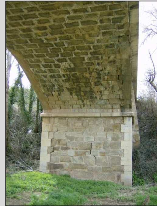
Fig. 5 Grietas en la bóveda y machón
