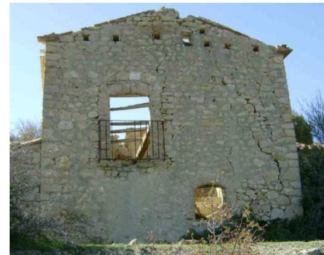
Fig. 9.4-13 Fachada de la Teuleria de la Mola, siglo XVIII-XIX. Dinteles y jambas de ladrillo cocido.
