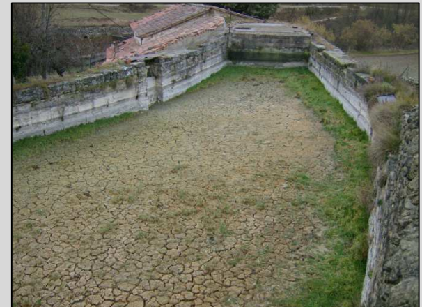
Fig. 11 Balsa y rampa cegada
