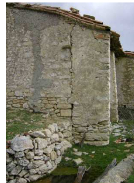
Fig. 9.4-3 Fisura, recrecido de muro
