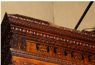
Fig. 41. Faltante en la cornisa arriba del sitial nº 20
