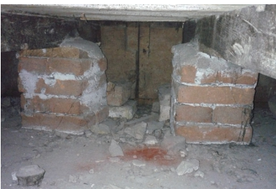
Fig. 29. Zona inferior del coro debajo de la plataforma: polvo y escombros
