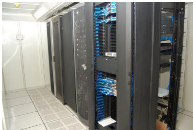
Ilustración 28. Fotografía del cuarto de los servidores y host.
