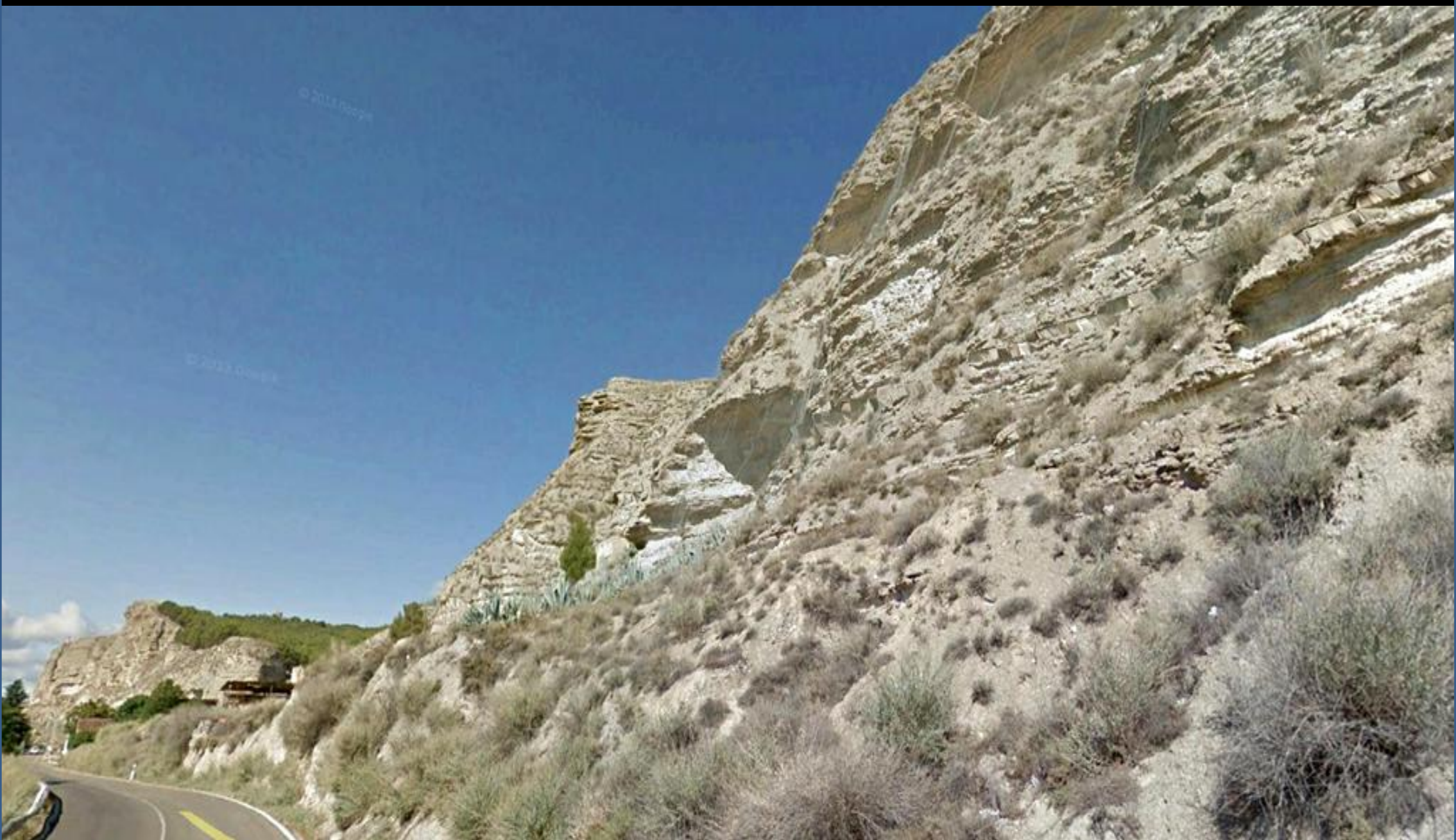
Detalle en anterior: Mallazo de estabilización en los cantiles de yesos, margas y limos yesíferos, Mioceno Inf. Terciario. NE de Calatayud, Zaragoza. SE Hoja.
