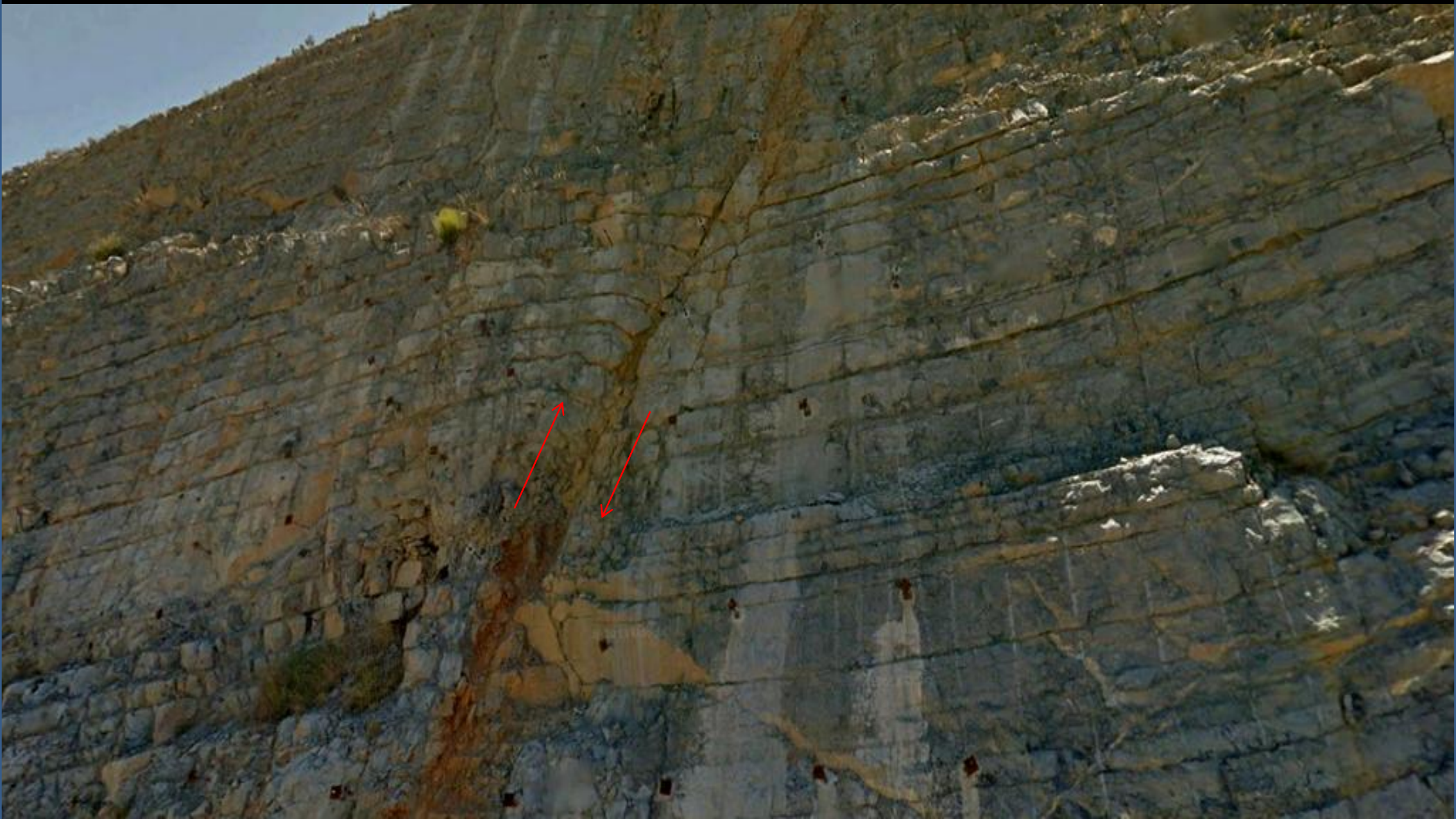
Bulones en el talud en la E90, de calizas- falla inversa- del Sinemuriense, Lias, Jurásico. Alto de La Perdiz, W de La Almunia de Doña Godina, Zaragoza. NW Hoja.
