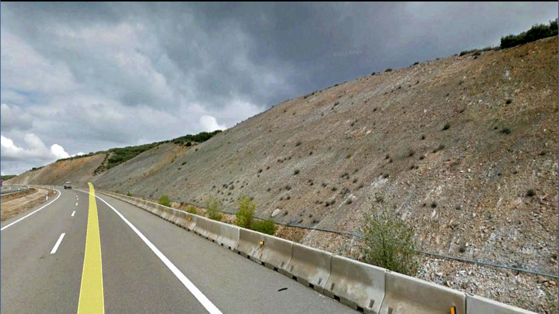
Mallazos en taludes tendidos de pizarras y cuarcitas del Tremadociense, Ordovícico Inf. A23, W de Cerveruela, Zaragoza. SE Hoja de Paniza.
