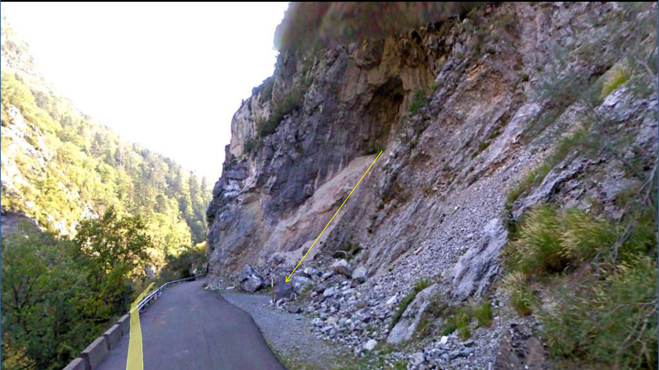
Inestabilidad en carretera. Boca del Infierno. NW Hoja de Ansó. Huesca.
