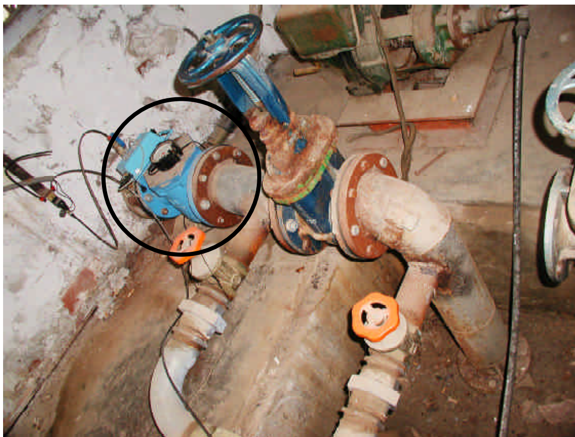
Figura 6.16. Imagen del caudalímetro y el data-logger instalados en Santa Bárbara.
