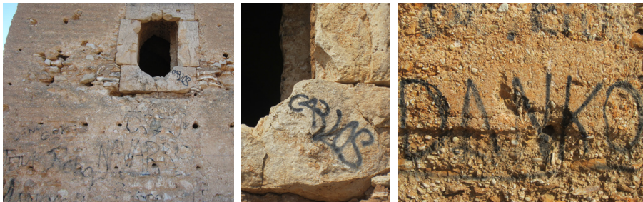
Fig. 8.19 - 8.21. Grafitis en la fachada Este, en el acceso y en la fachada Sur.
