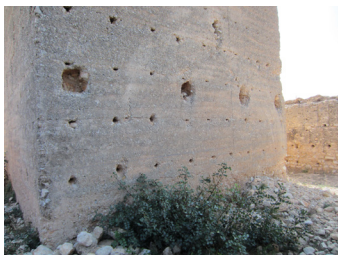
Fig. 6.22 - 6.25. Vista coronación. Detalle hueco nivel 3. Detalle erosión del nivel 2. Vista de la base de la Torre.
