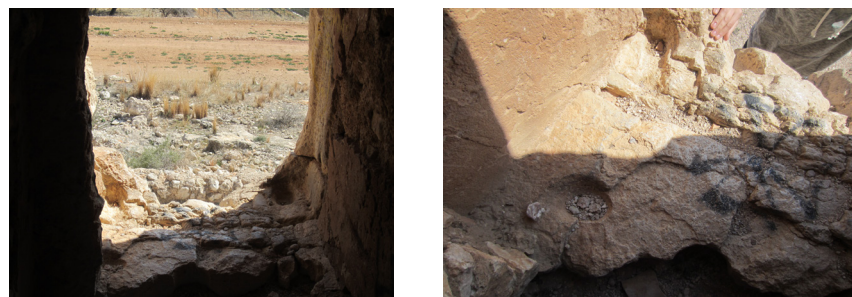
Fig. 6.77 - 6.78. Detalle del desgaste de la sillería del acceso.
