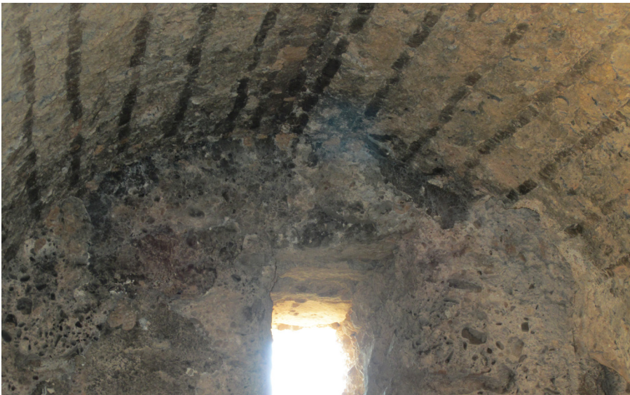
Fig. 8.31. Humedades en la bóveda del nivel 1.
