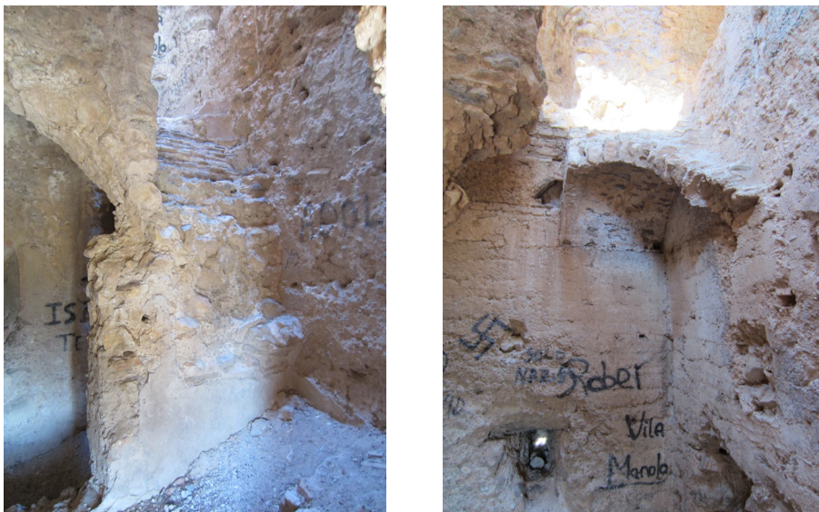
Fig. 8.63 - 8.64. Restos de la escalera del nivel 1 y vista de la bóveda de arranque de la escalera del nivel 3.
