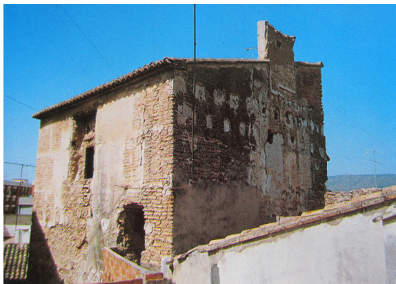
Fig. 4.43. Cuerpo superior de la torre, antes de la intervención, en el que se observa el exterior de los huecos.
