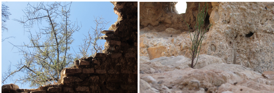
Fig. 8.17 - 8.18. Arbustos nacidos en la cubierta y en el forjado del nivel 3.
