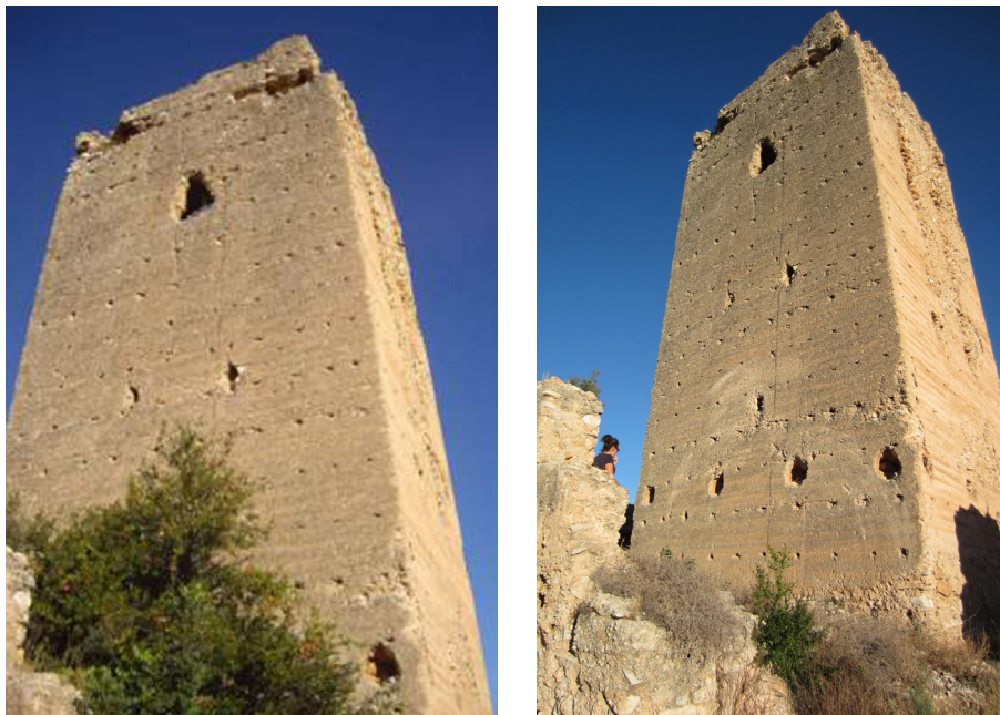
Fig. 8.29 - 8.30. Imagen del árbol que provocó la erosión y vista del alzado Oeste sin el árbol.
