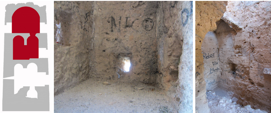
Fig. 6.39 - 6.40. Vista del intradós Sur. Detalle de la bóveda de la escalera del nivel 2 al nivel 3.
