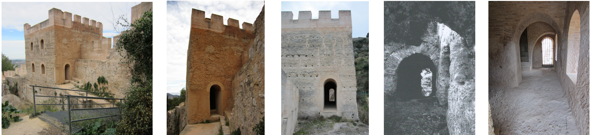
Fig. 4.128 - 4.132. Vista de la entrada a la torre por el lado Sur. Vista del acceso de la fachada Norte. Comparativa del estado previo y el estado actual del acceso de la cara Sur desde el interior.
