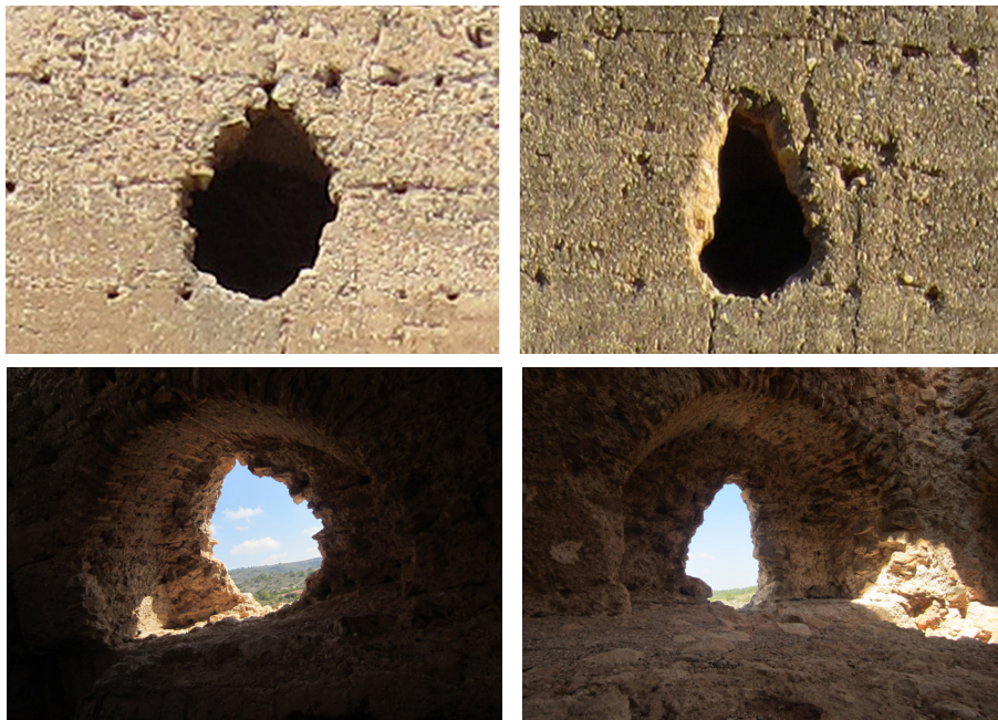
Fig. 8.49 - 8.52. Oquedades irregulares de la fachada Este y Oeste.
