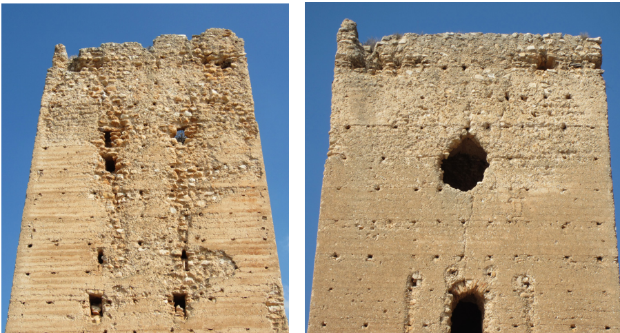
Fig. 8.36 - 8.37. Pérdida de costra en el alzado Sur y Este.
