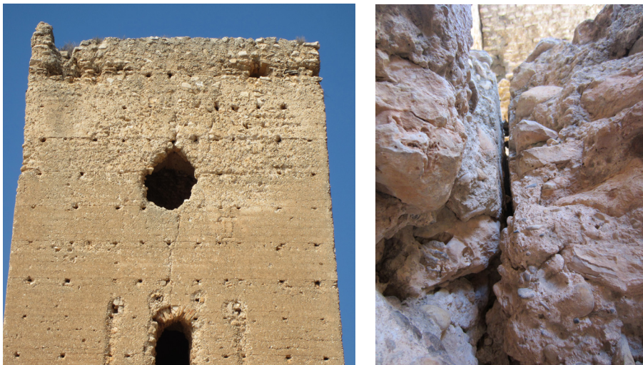
Fig. 8.5 - 8.6. Grietas en el alzado Este y en la unión del forjado con el muro del nivel 3.
