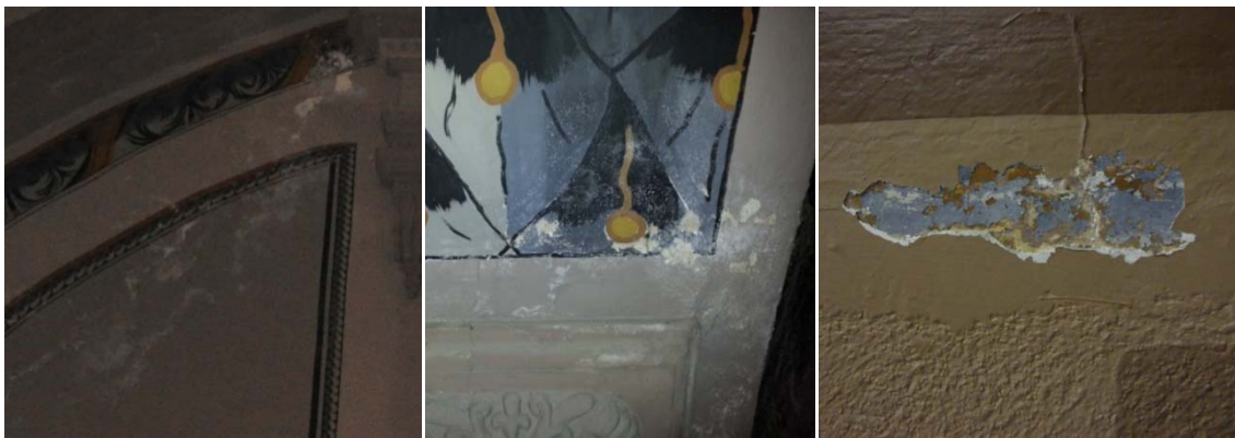
6.795, 6.796 Humedades que producen sales y desconchados.
