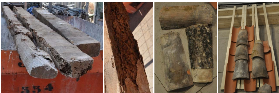
6.416,6.417 Vigas retiradas en mal estado.
