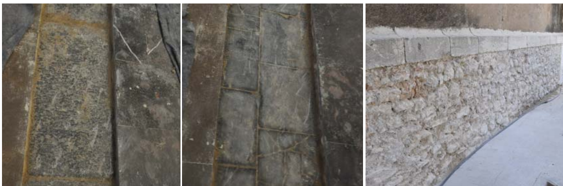
Imagen 3.52 y 3.53 Pavimento doblado.
