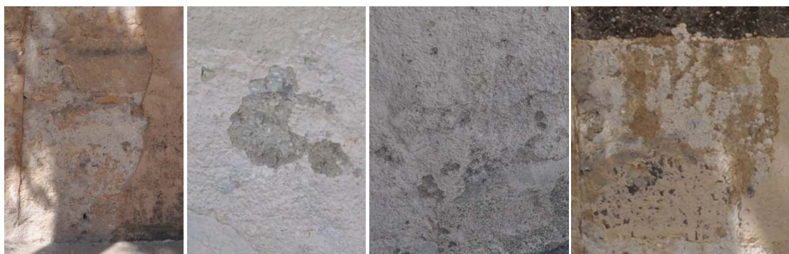
Grupo de imágenes 6.285 Desconchado y caída de revestimiento.
