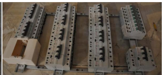
6.671 Elementos del nuevo cuadro de protección.
