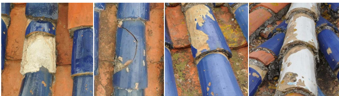
Grupo de imágenes 6.370 Rotura y pérdida de material.
