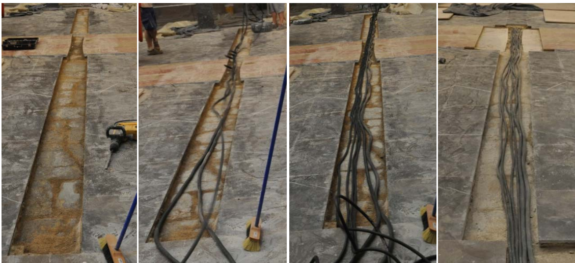
Grupo de imágenes 6.667 Paso de cableado por la regata de la nave central.
