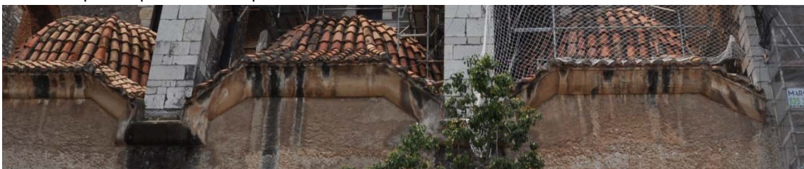
6.281 Estado anterior a la intervención.
