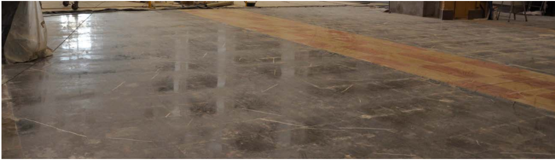
6.769 Estado anterior a la intervención.
