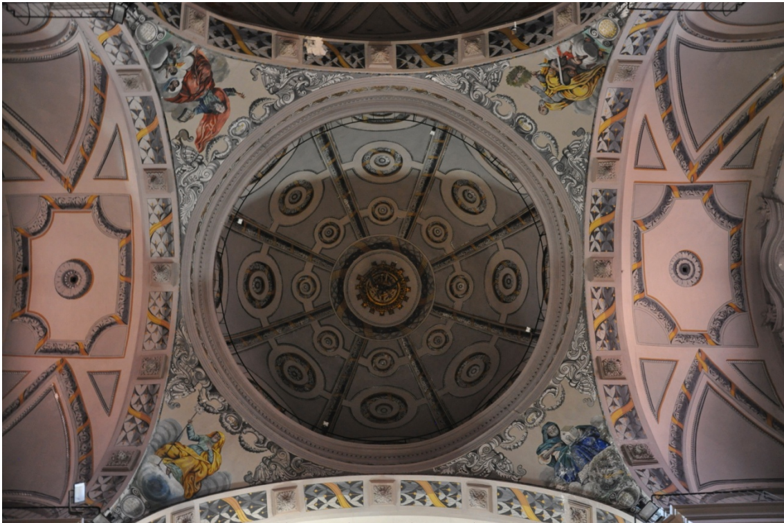
6.909 Estado anterior a la intervención.
