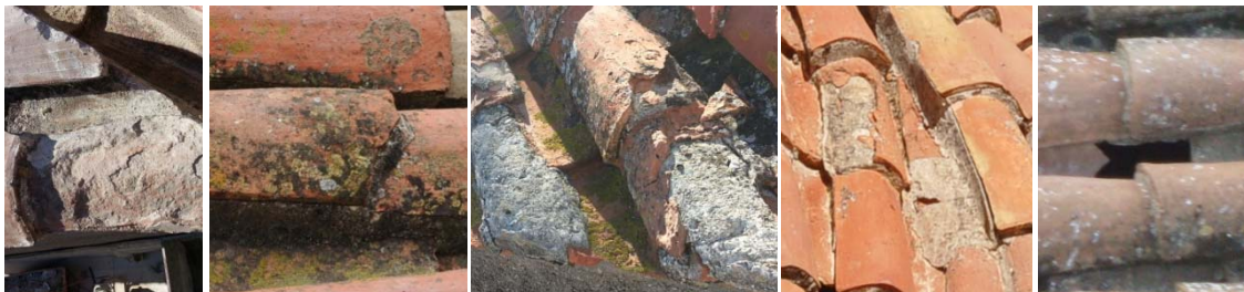
Grupo de imágenes 6.406 Rotura y pérdida de material.
