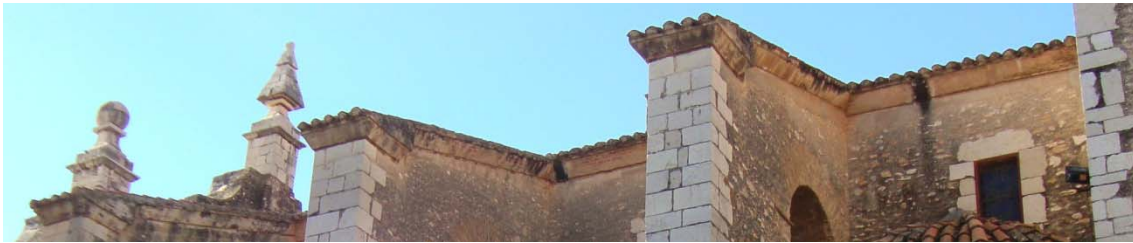
6.273 Estado anterior a la intervención.
