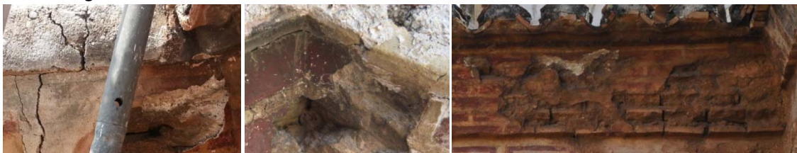
Grupo de imágenes 6.220 Pérdidas y disgregación de material.
