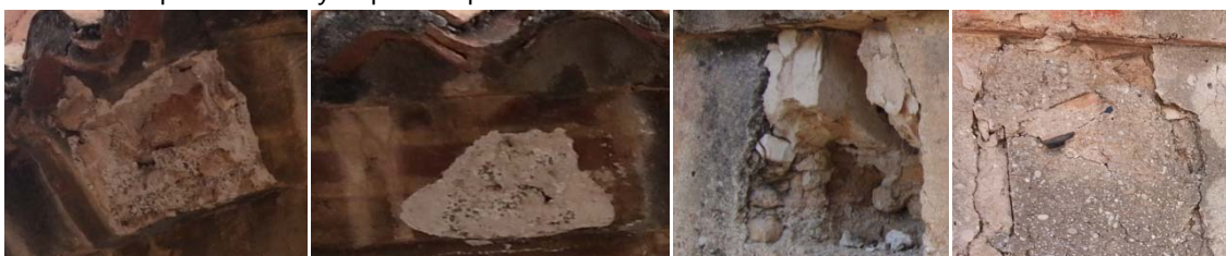
Grupo de imágenes 6.223 Pérdidas y disgregación de material.
