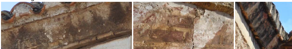
Grupo de imágenes 6.197 Costra negra y escorretías.
