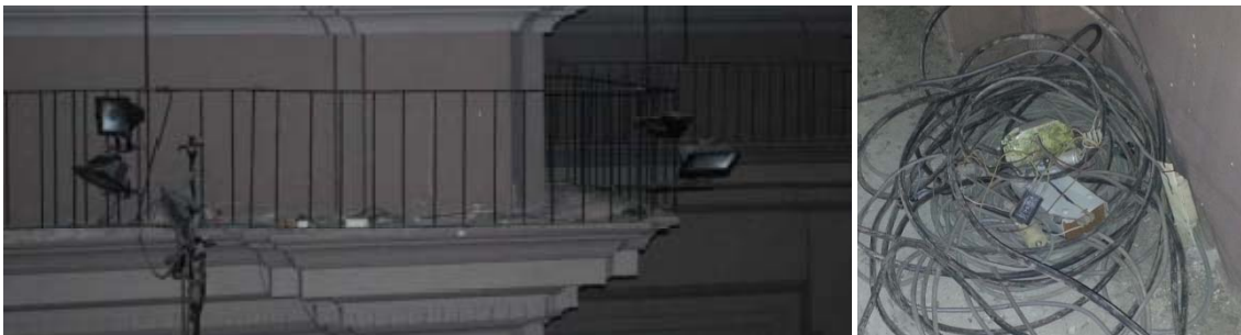
Grupo de imágenes 6.654 Encuentros conflictivos en cubiertas.
