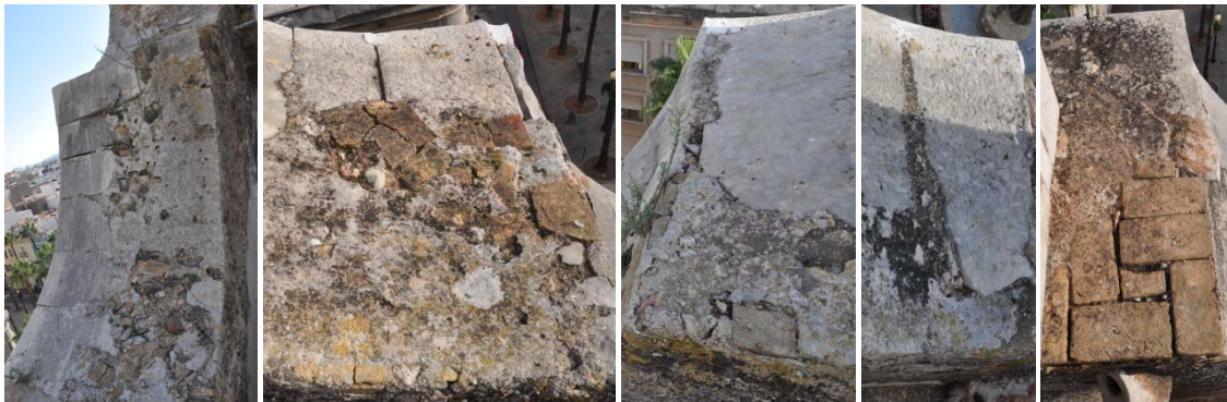
Grupo de imágenes 6.256 Suciedad y desprendimiento de material.
