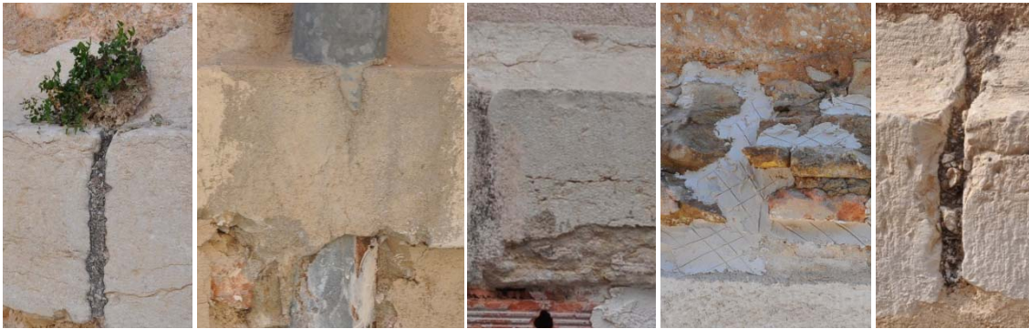
Grupo de imágenes 6.308 Pérdidas y disgregación de material.
