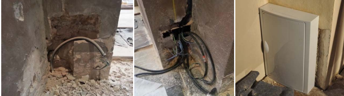
Grupo de imágenes 6.676 Uniones de cableado en caja accesible en pilastra.
