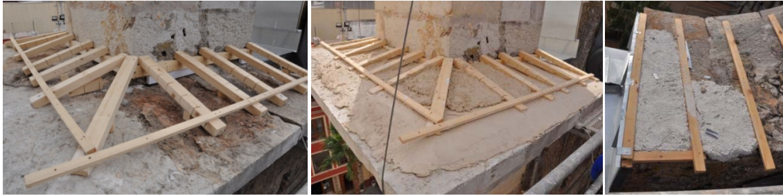
Grupo de imágenes 6.259 Estructura de madera y mortero con la inclinación necesaria.
