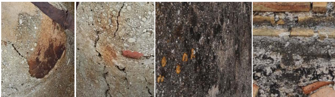
6.482,6.483 Óxido de la veleta cúpula central. 6.484,6.485 Manchas de costra negra.
