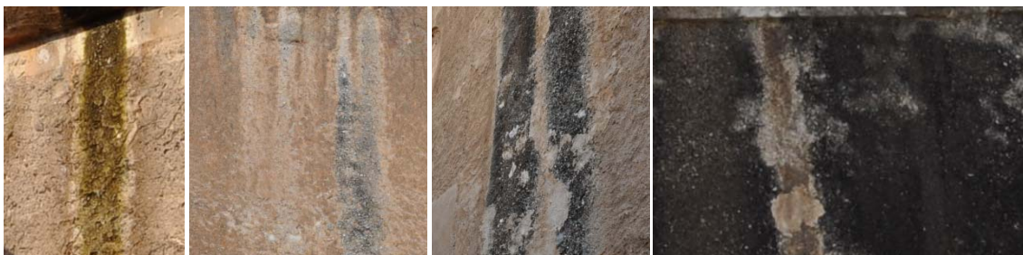
6.175 Biodeterioro. 6.176, 6.177, 6.178 Escorrentías y costra negra.
