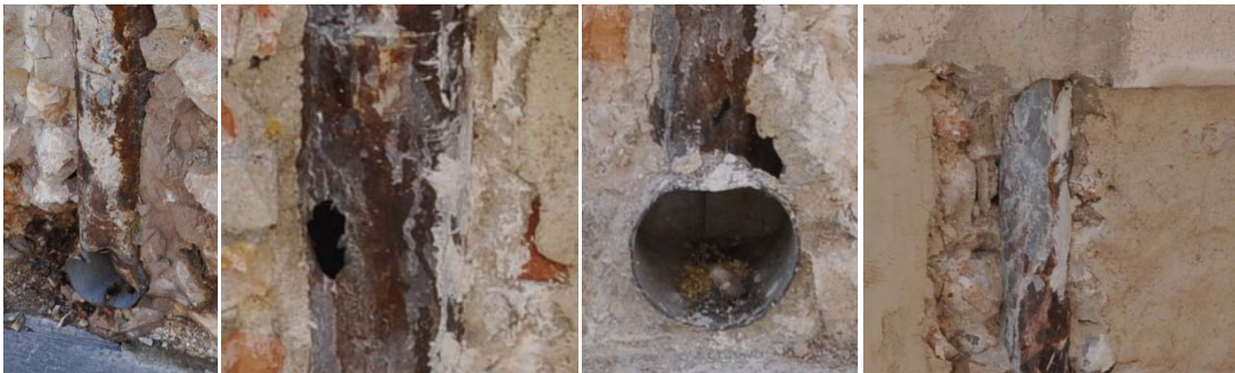
Grupo de imágenes 6.318 Bajantes oxidadas.
