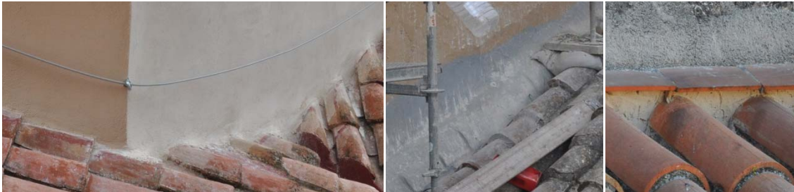
Grupo de imágenes 6.611 Encuentros conflictivos en cubiertas.
