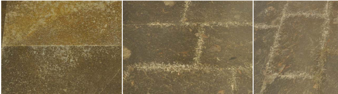
Grupo de imágenes 6.734 Eflorescencias en el pavimento.
