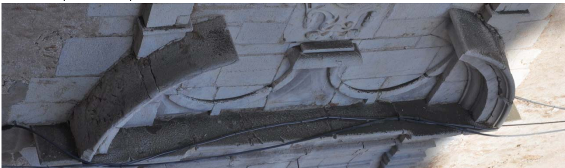
Imagen 6.101 Suciedad y desprendimiento de material.
