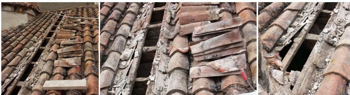
Grupo de imágenes 6.412 Estado del faldón a cambiar.
