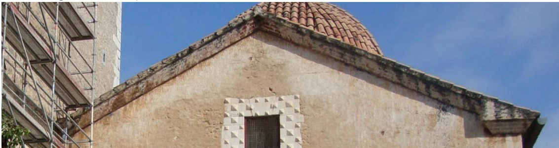
6.269 Estado anterior a la intervención.
