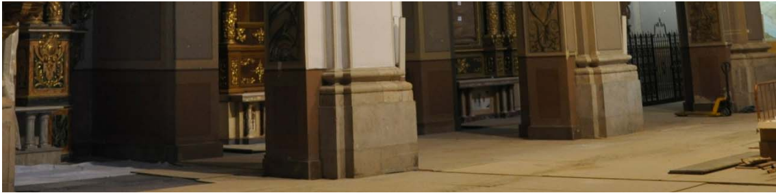
6.730 Estado anterior a la intervención.
