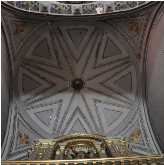
6.905 Estado anterior a la intervención.
