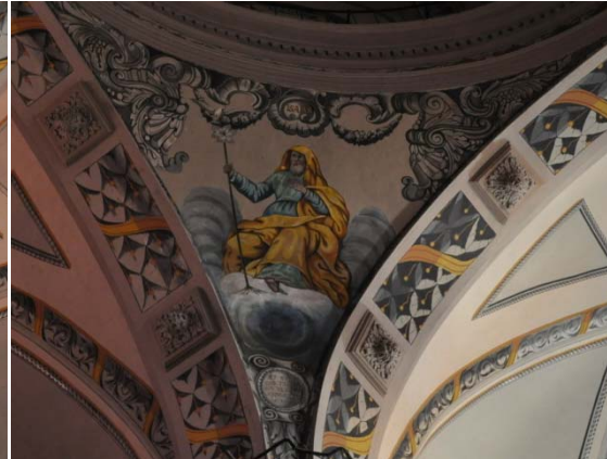
6.916 Estado anterior a la intervención.
