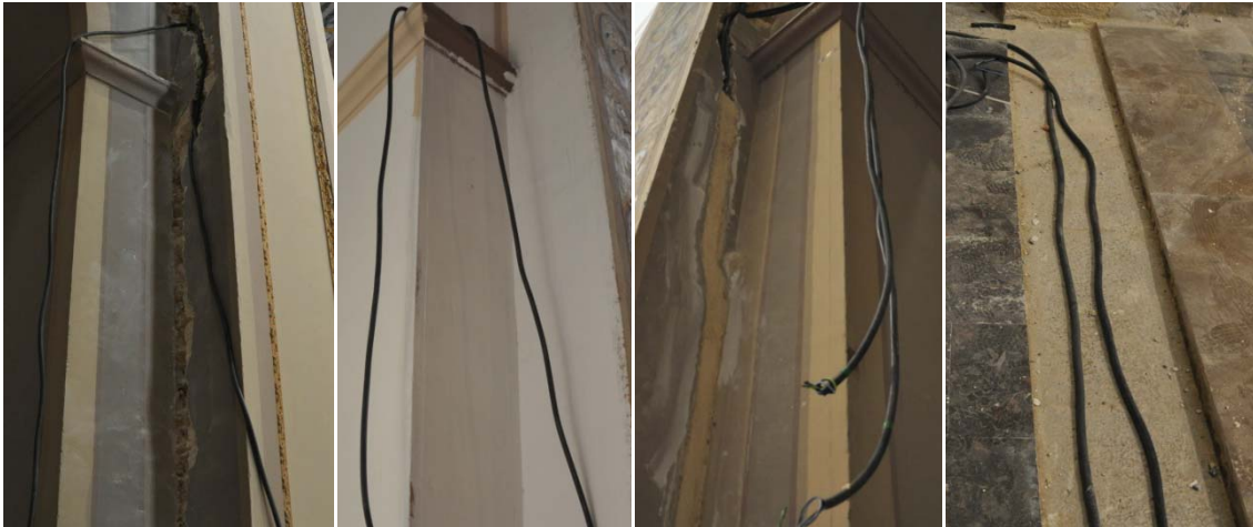
Grupo de imágenes 6.665 Paso de cableado por las pilastras.
