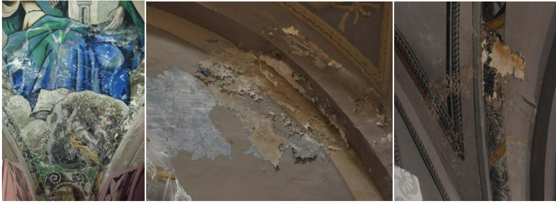
Grupo de imágenes 6.794 Humedades que producen sales y desconchado de pintura.
