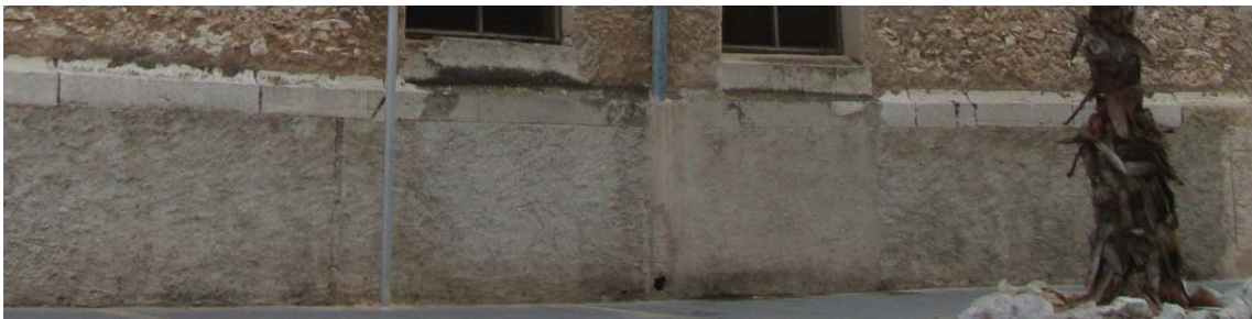
6.338 Estado anterior a la intervención.
