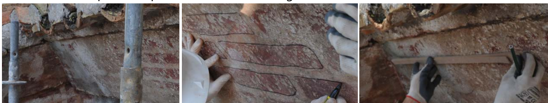
6.244 Cornisa en mal estado.
