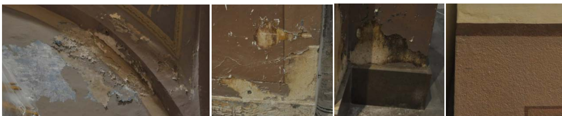
6.705,6.706,6.707 Desconchados de pintura y humedad por capilaridad
