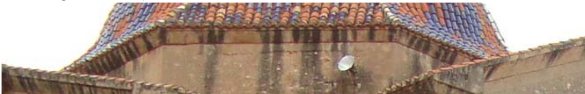
6.279 Estado anterior a la intervención.
