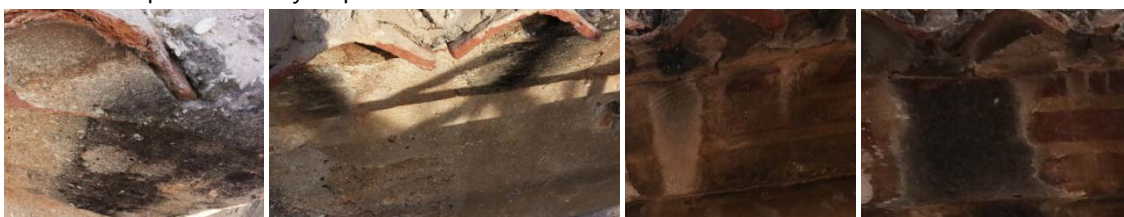
Grupo de imágenes 6.203 Costra negra y escorretías.
