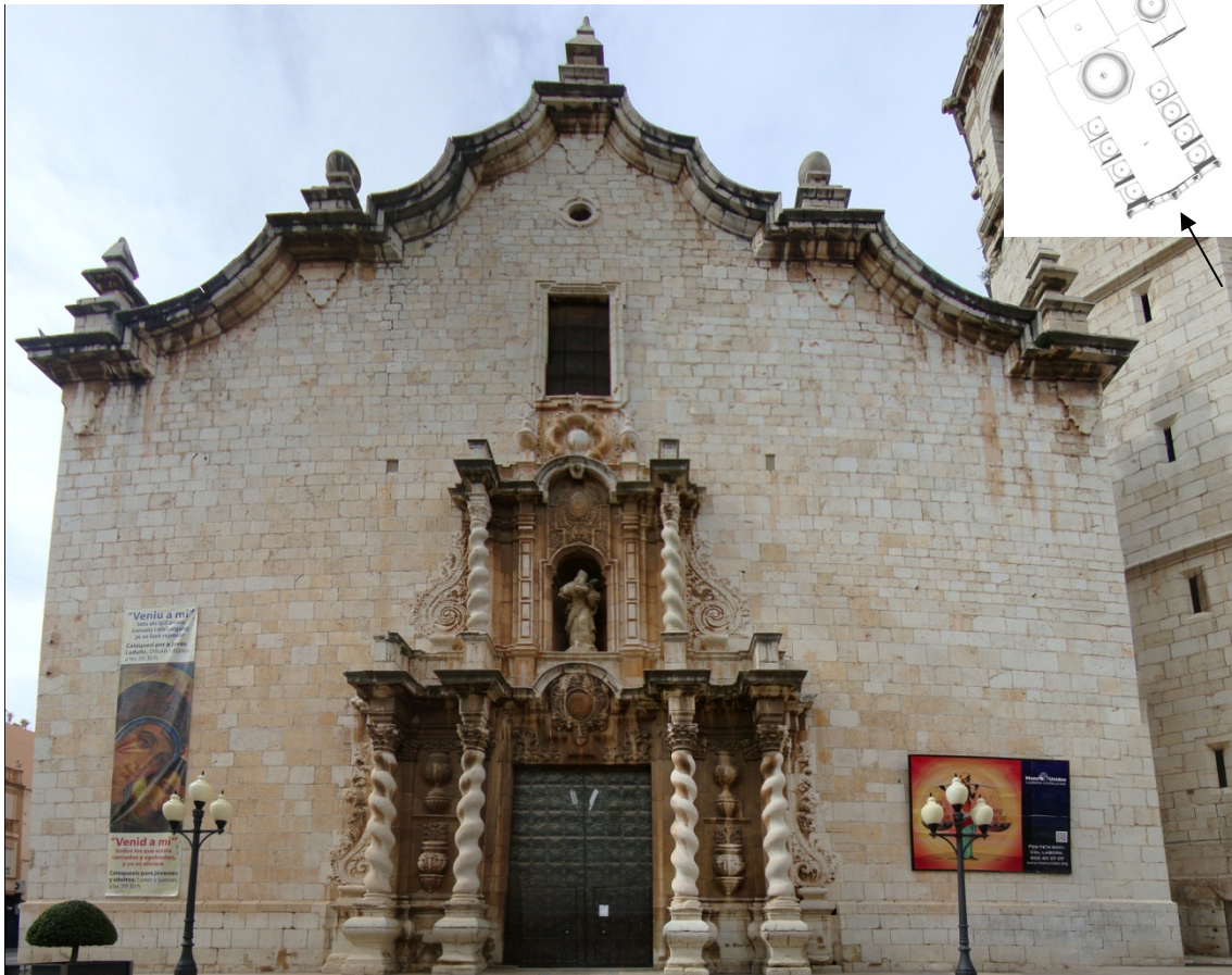
6.643 Estado anterior a la intervención.
