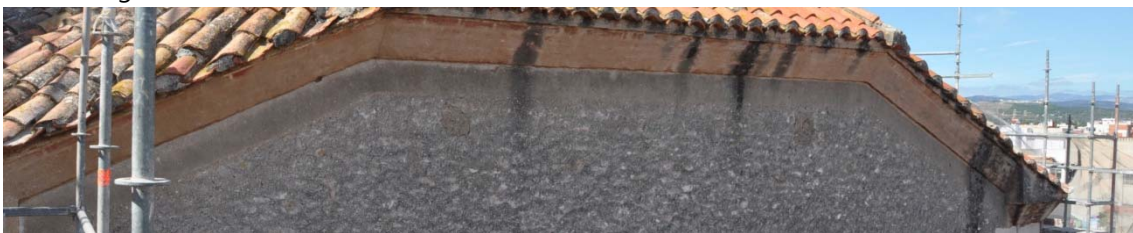
6.275 Estado anterior a la intervención.
