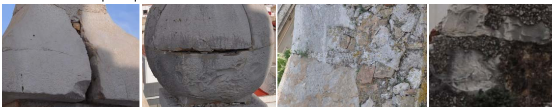
Grupo de imágenes 6.221 Pérdidas y disgregación de material.
