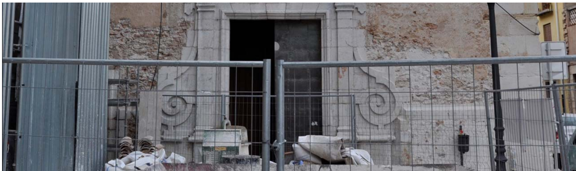
6.159 Fachada sin mortero de cemento en la que colocar mortero de cal.
