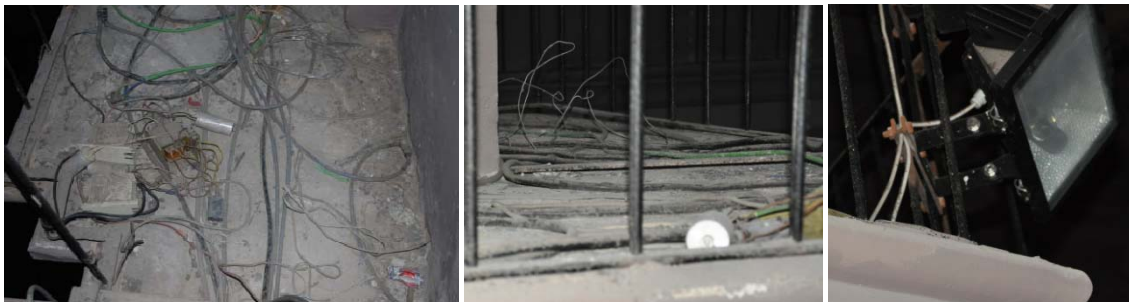
Grupo de imágenes 6.653 Encuentros conflictivos en cubiertas.
