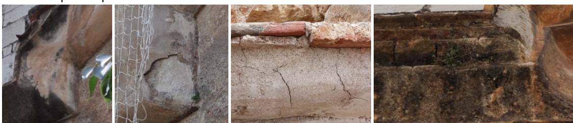
Grupo de imágenes 6.222 Pérdidas y disgregación de material.
