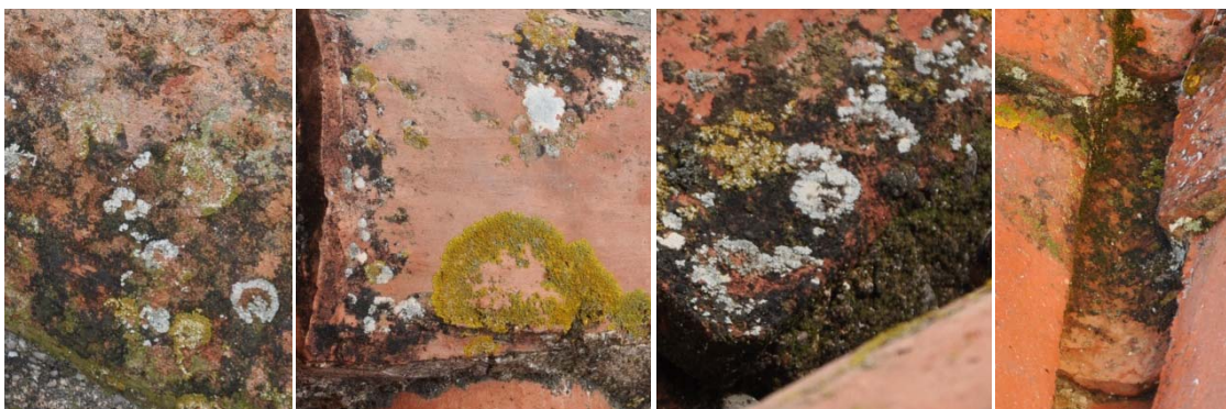
Grupo de imágenes 6.405 Biodeterioro y manchas.
