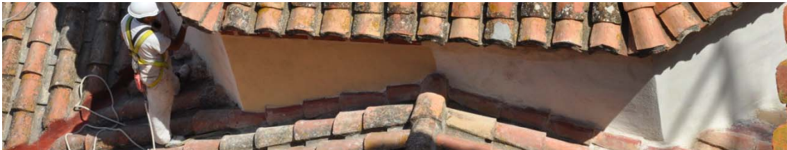
6.637 Estado anterior a la intervención.
