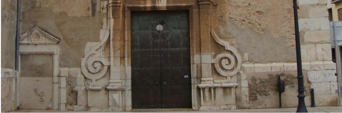
6.173 Estado anterior a la intervención.
