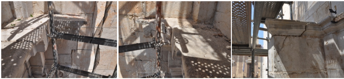
Grupo de imágenes 6.43 Pérdidas de material de mayor volumen.
