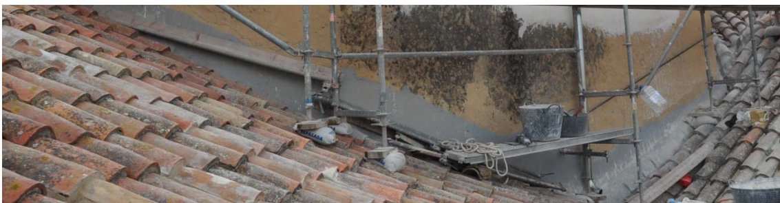
6.639 Estado anterior a la intervención.
