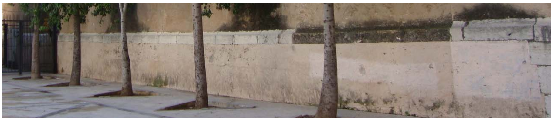
6.340 Estado anterior a la intervención.
