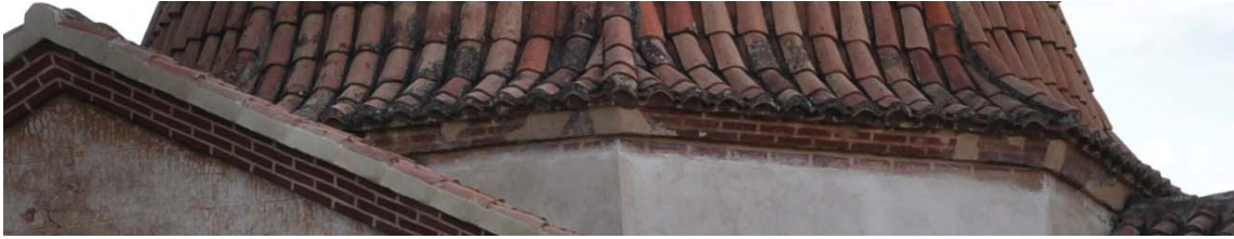
6.277 Estado anterior a la intervención.
