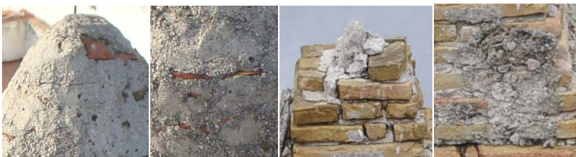
6.490,6.491 Pérdidas de material pináculo ábside. 6.492,6.493 Pérdidas de material pináculo Capilla.
