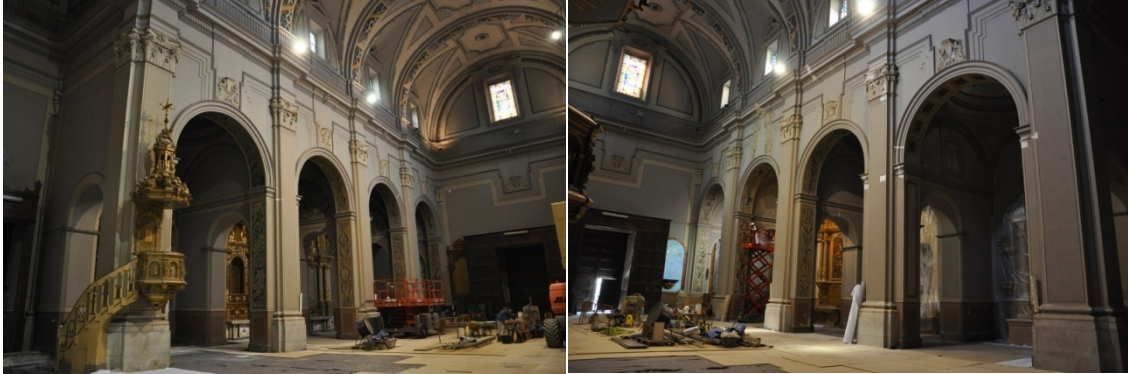
6.901 Estado anterior a la intervención.
