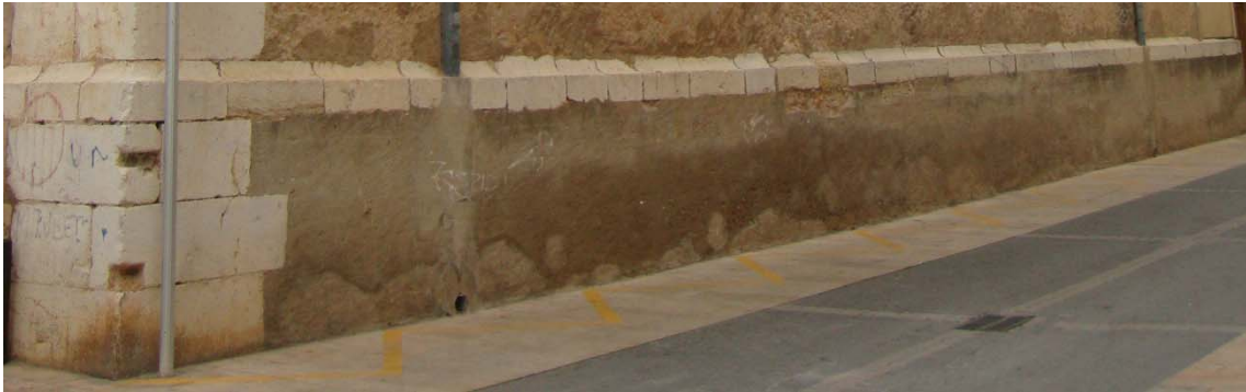
6.336 Estado anterior a la intervención.
