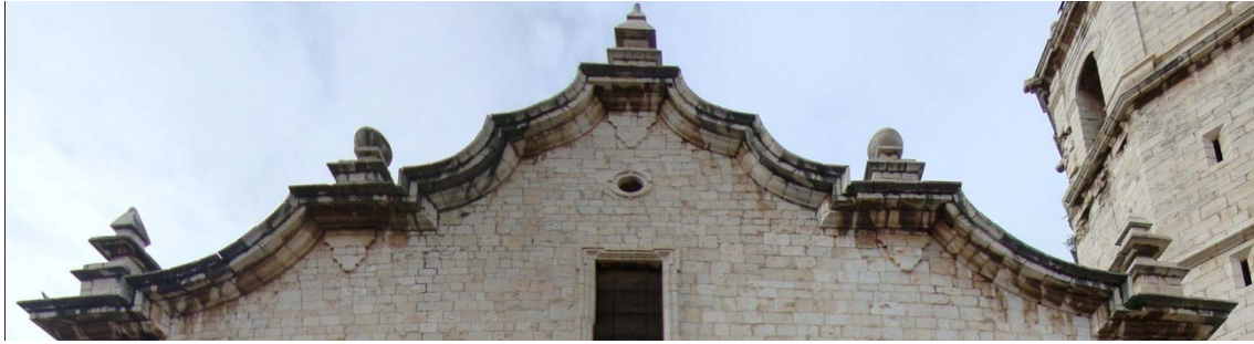
6.283 Estado anterior a la intervención.
