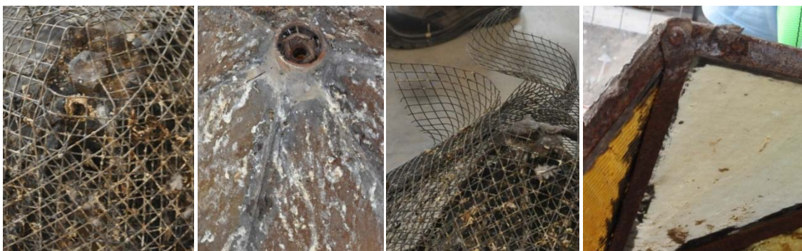
6.529,6.530,6.531 Depósito superficial y rotura malla.
