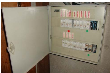
6.672 Antiguo cuadro eléctrico.
