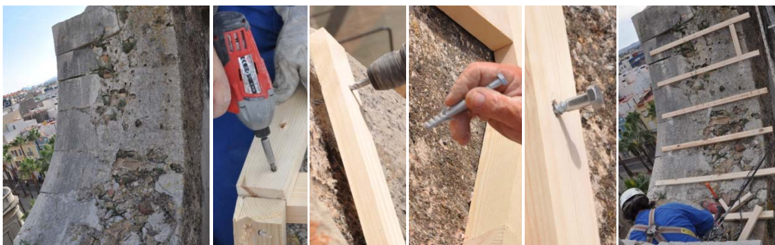
Grupo de imágenes 6.258 Atornillado de la estructura de madera a la cornisa.
