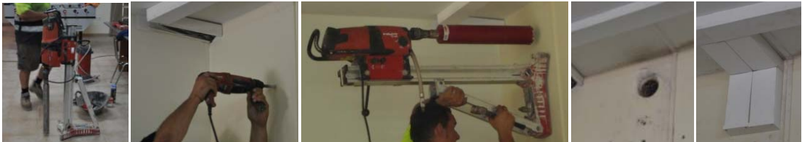
Grupo de imágenes 6.669 Paso de realización del agujero para paso de cableado.
