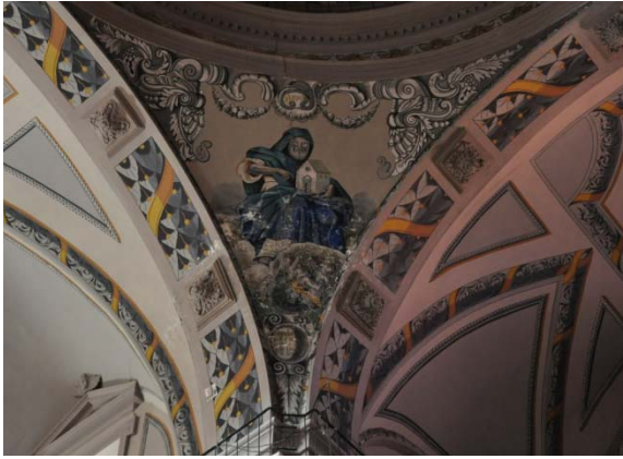
6.911 Estado anterior a la intervención.
