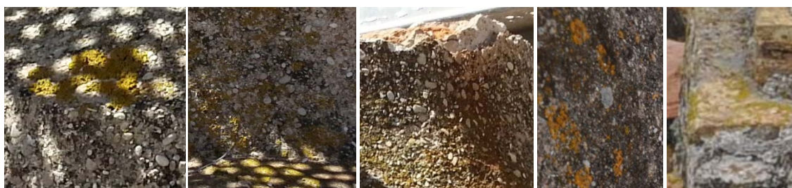
Grupo de imágenes 6.481 Biodeterioro en pináculos.
