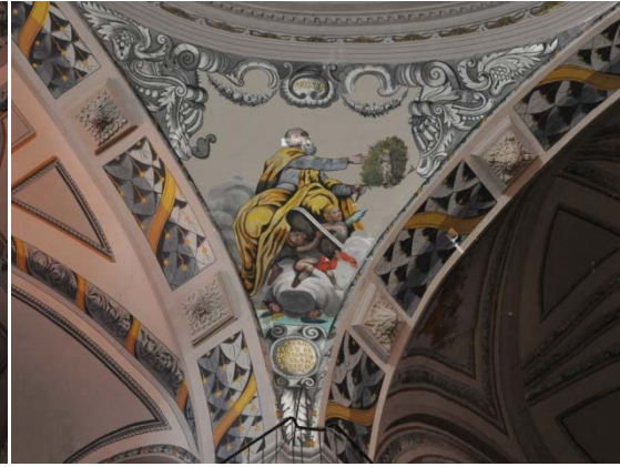
6.912 Estado anterior a la intervención.
