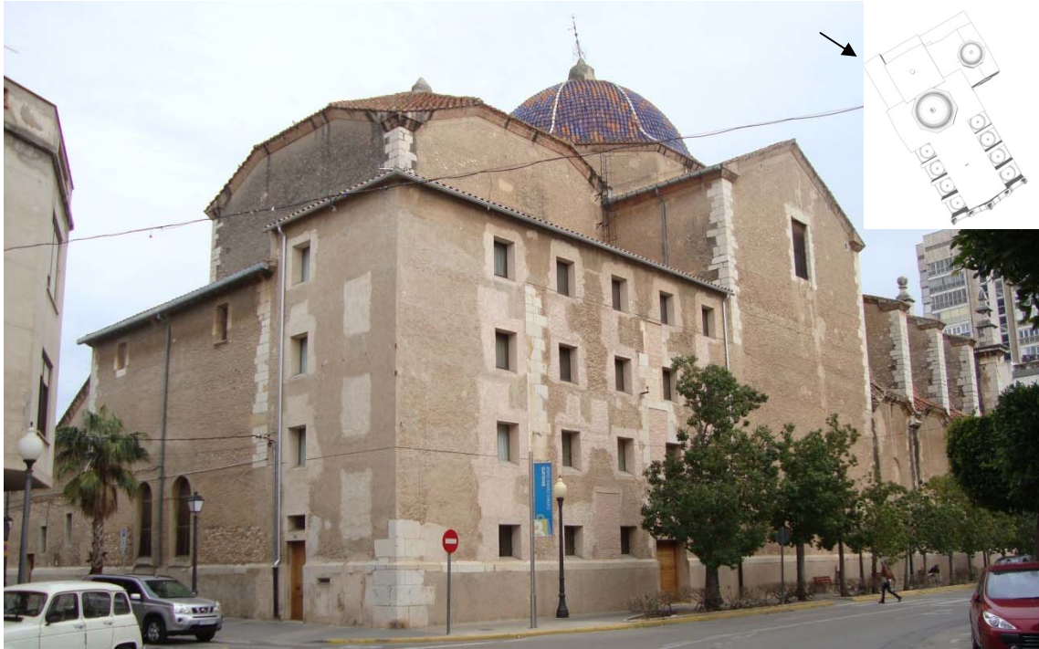
6.651 Estado anterior a la intervención.
