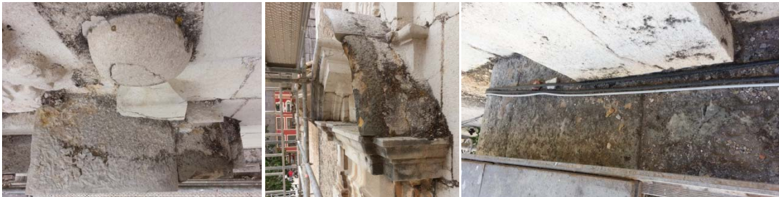
Grupo de imágenes 6.100 Suciedad y desprendimiento de material.
