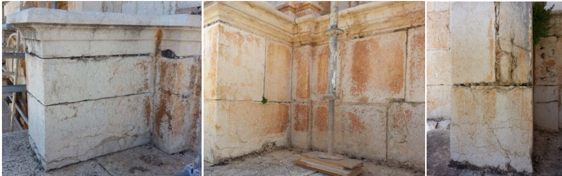
Grupo de imágenes 6.44 Erosión de juntas.
