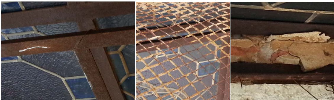
Grupo imágenes 6.342 Oxidación.
