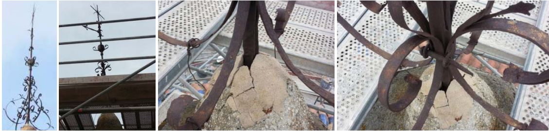
Grupo de imágenes 6.562 Estado de la veleta antes de su retirada.
