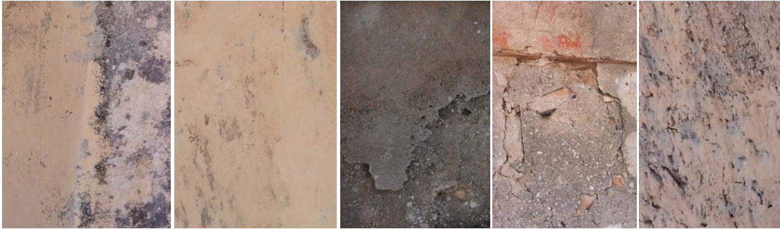
Grupo de imágenes 6.469 Desconchado y caída de revestimiento.
