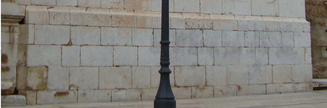
6.144 Estado anterior a la intervención.
