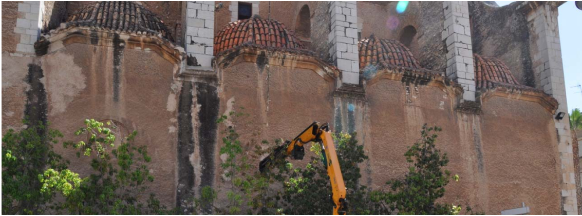
6.185 Estado anterior a la intervención.
