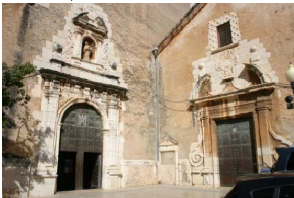
6.647 Estado anterior a la intervención.
