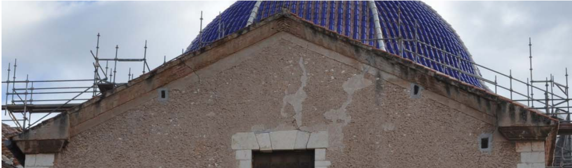
6.267 Estado anterior a la intervención.
