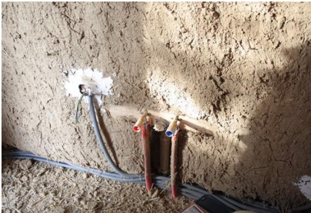
Fig. 88 Canalizaciones de agua – www.casadepaja.es
