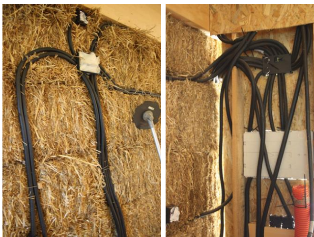
Fig. 90 paso de instalaciones eléctricas – www.casadepaja.es
