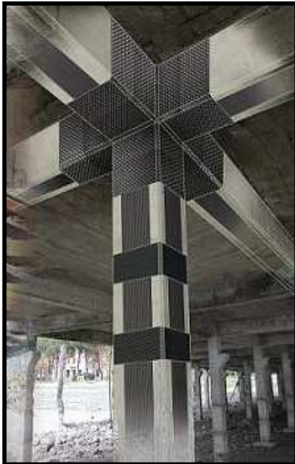
Ilustración 14. Cruce de vigas y pilar reforzado con fibra de carbono. Fuente: Internet.
