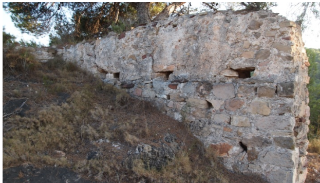
Restos de muro de mampostería
