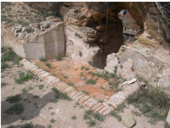
Detalle de la pila de desagüe en las cocinas
