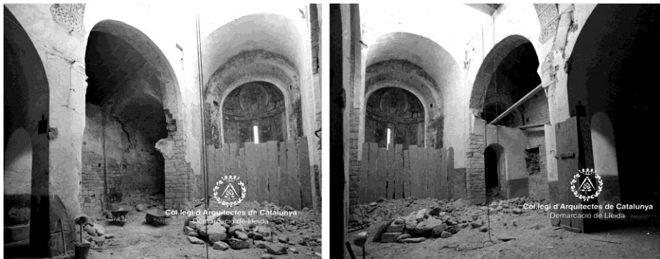
Fig. 322 Taull. Iglesia de Santa María AFAFV. Fotografías del ábside central y de los muros que cierran los laterales. Ejecución de las demoliciones
