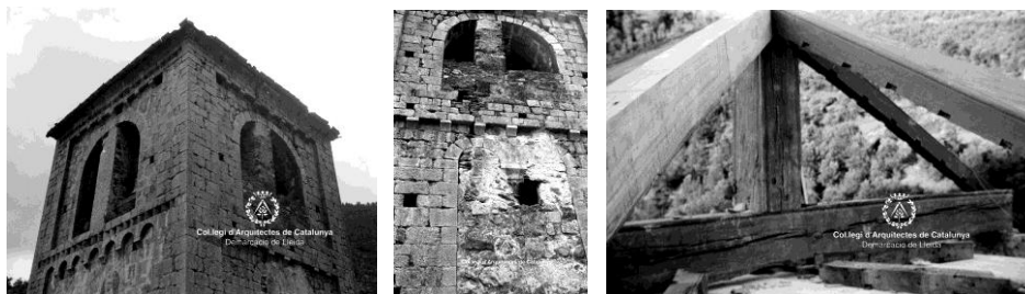
Fig. 119 Beget. Iglesia de San Cristóbal AFAFV. Estado inicial de los dos cuerpos superiores del campanario y nuevo entramado de madera para la cubierta
