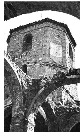
Estado previo a la restauración
