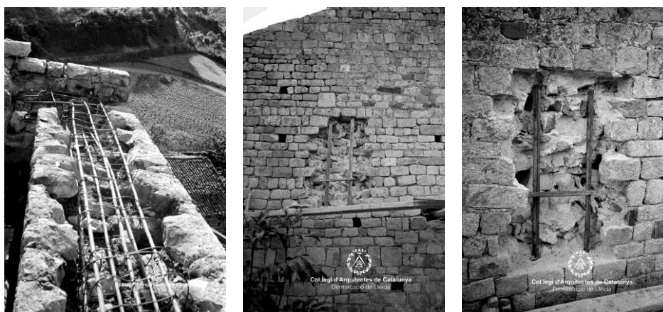
Fig. 55 Santa Eulalia de Erilla la Vall. AFAFV. Hierro en zunchos perimetrales y en refuerzos puntuales en muros
