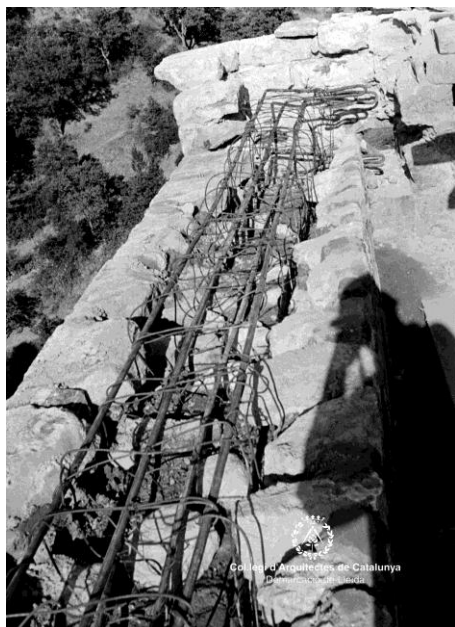
Fig. 120 Beget. Iglesia de San Cristóbal AFAFV. Zuncho perimetral en la coronación del campanario
