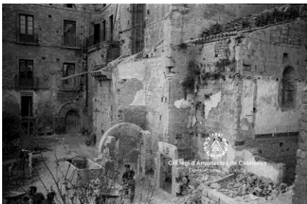
Fig. 285 Vallbona de las Monjas. Monasterio de Santa María AFAFV. Brazo del crucero durante las demoliciones de las edificaciones
