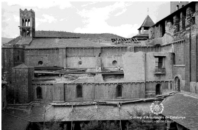
Fig.262 Seo de Urgel. Catedral de Santa María AFAFV. Desmontaje de la cubierta de la galería Este durante su restauración
