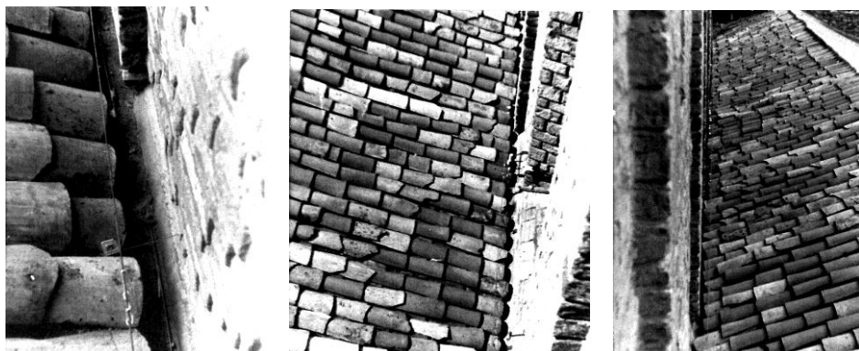
Fig. 169 Ripoll Monasterio de Santa María AAFV. Fotografías del encuentro de la cubierta del pórtico con el muro de la fachada de la iglesia
