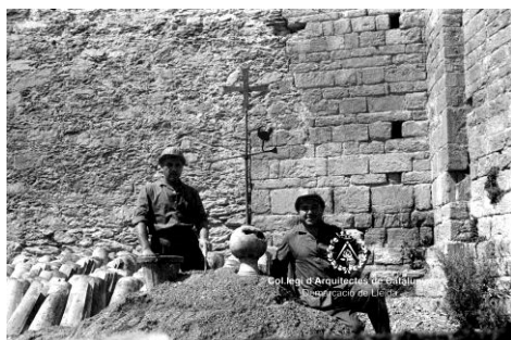
Fig.58 Iglesia de San Cristóbal de Beget AFAFV. La fotografía documenta la diferencia entre el muro demolido y el elemento original
