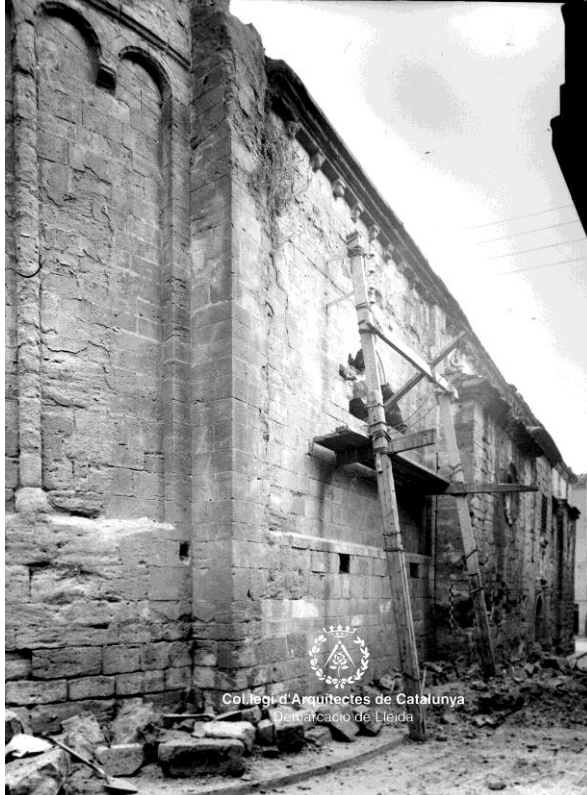
Fig. 242 Agramunt. Iglesia de Santa María AFAFV. Inicio de los trabajos de demolición de la doble fachada
