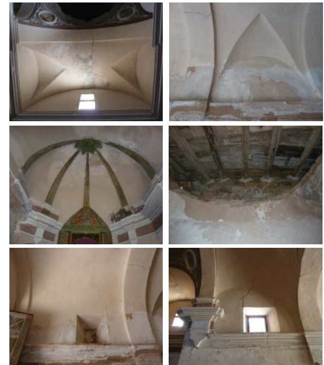
figura 4.1 - 4.2 - 4.3 - 4.4 Estado actual de la bóveda que cubre los transeptos, el luneto de la bóveda central, la cubrición de la cabecera, y la bóveda de la sacristía. Fuente propia
