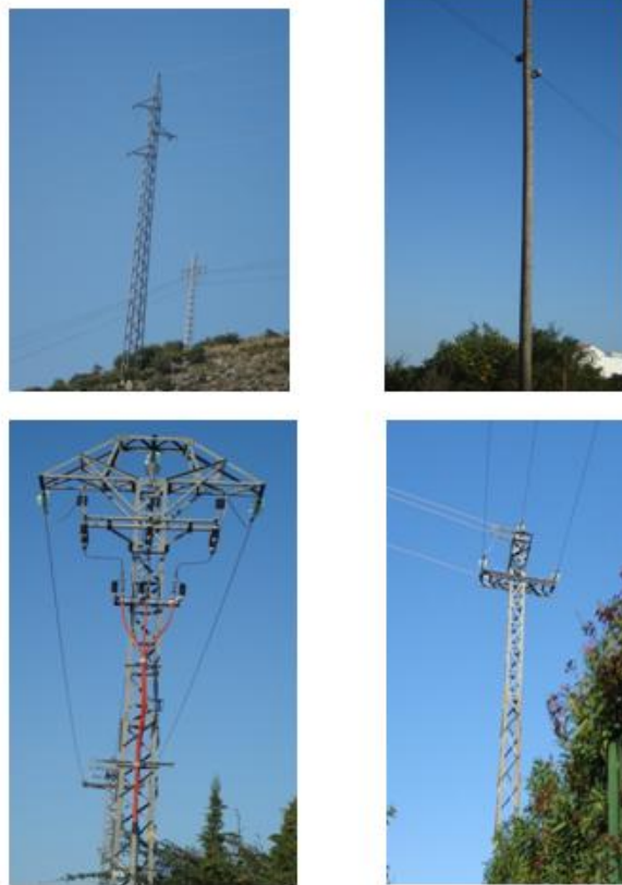
Fotos de diseños de postes eléctricos peligrosos
