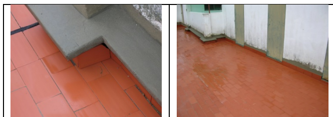
Imagen 13. Reparación realizada en el año 2004 en la azotea.
