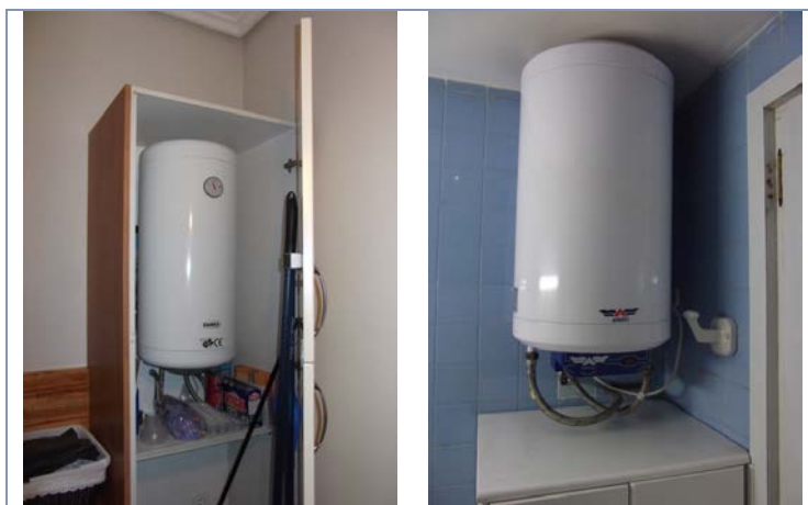
Imagen 80. Generación de ACS en edificio objeto actualmente. Fuente: la propiedad.
