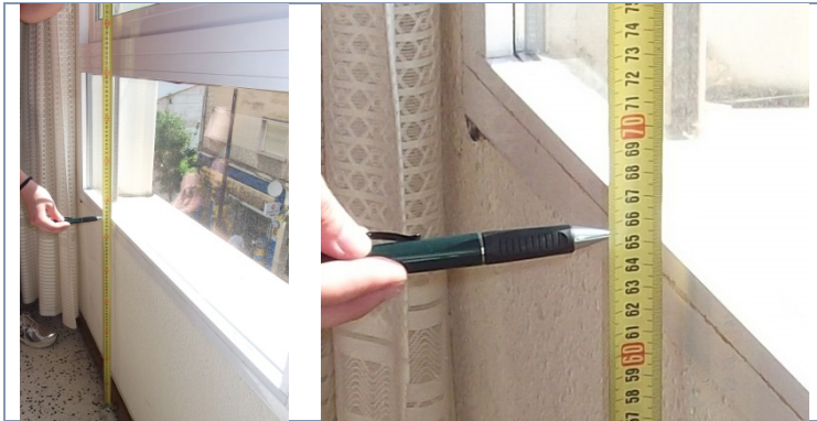
Imagen 55. Edificio objeto. Antepecho de vidrio en zona con riesgo de impacto.
