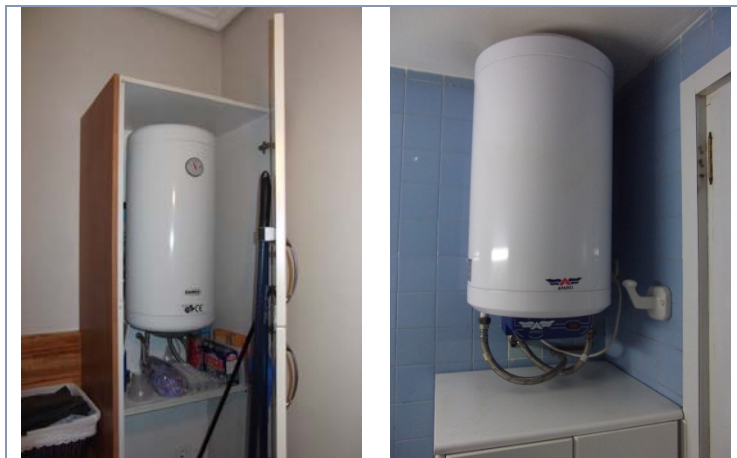
Imagen 23. Generación de ACS en edificio objeto. Fuente: La propiedad.
