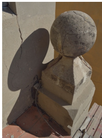
Detalle del remate de la pilastra junto a la torre en la fachada Sur.
