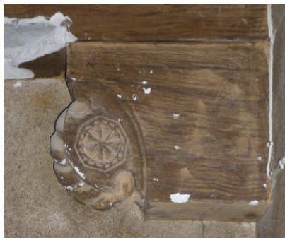
Detalle de la ménsula de las viguetas en el comedor de la vivienda.
