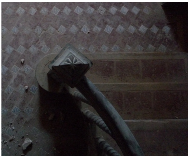
Escalones de baldosa cerámica con el remate de madera en el canto del escalón
