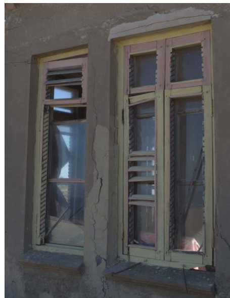
Grietas en los elementos de ladrillo entre las ventanas
