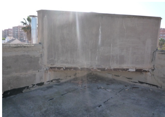
Depósito de agua en la cubierta, que se va a eliminar al haber perdido su función.
