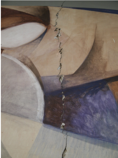
Figura 20 (a la izquierda). Grieta y desprendimientos de pintura.
