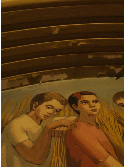
Figura 66 (a la izquierda). Descamaciones de la pintura.
