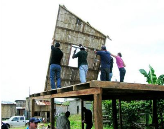
Ilustración 132: colocación de paneles prefabricados de "caña picada" usados como cerramiento de los edificios. Fuente: F. Jové (2011).
